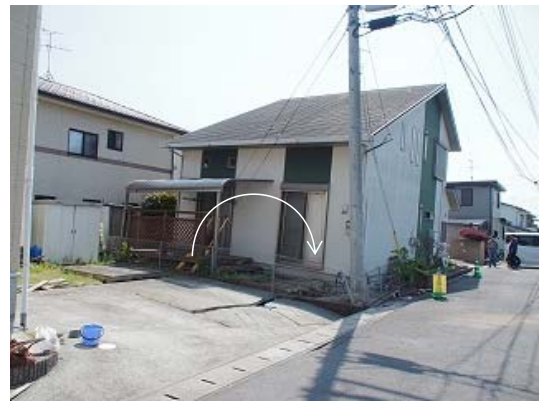
住宅の傾斜・沈下
