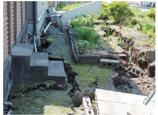
住宅周りの地盤変状
