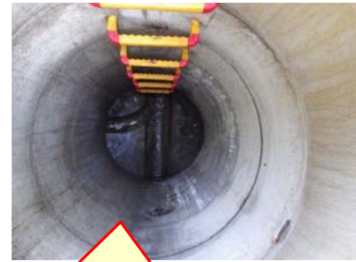
浮上したマンホールの内部 損傷は確認できず
