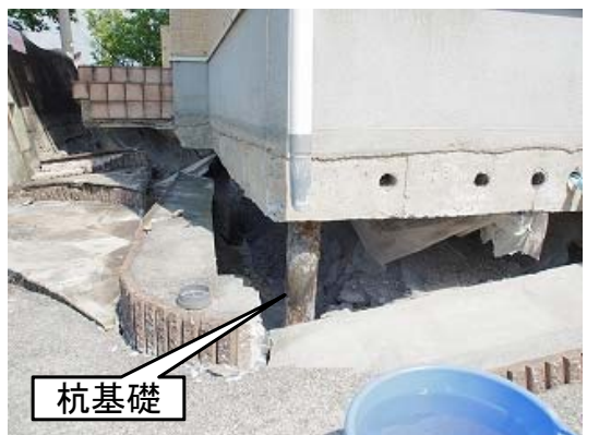
住宅周りの地盤変状
