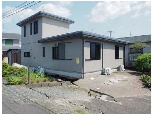
住宅周りの地盤沈下
