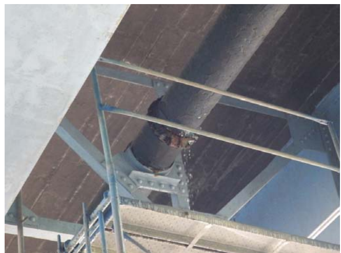
添架管の漏水(2)
