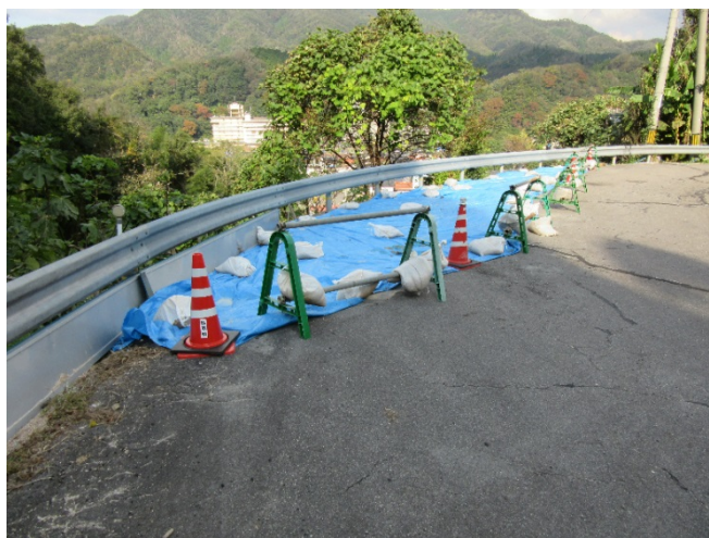
写真 2.21 ③部にみられる路面の陥没
