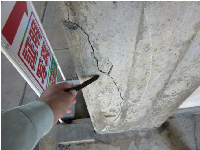
写真2.5 市役所(本庁舎)の柱基部の損傷状況
