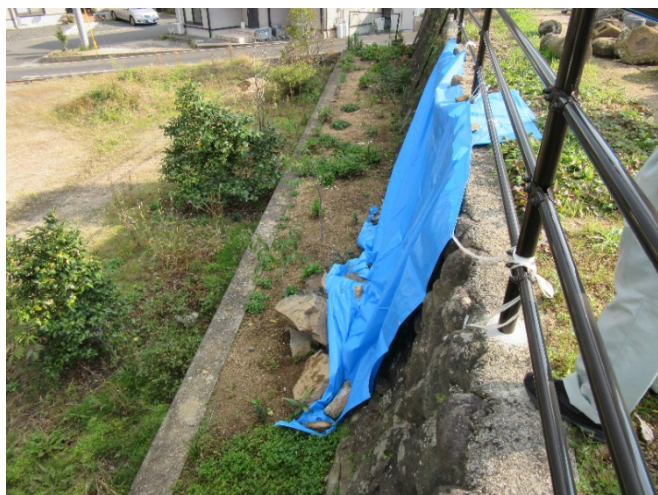
写真2.2 石積擁壁の崩壊
