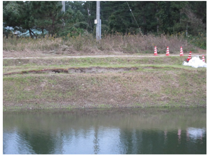
写真 2.28 堤防法面のすべりによる段差
