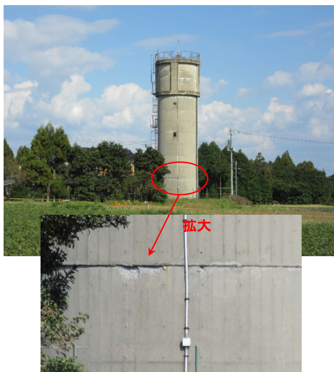
写真2.18 配水塔全景及び打継目の欠損(拡大)
