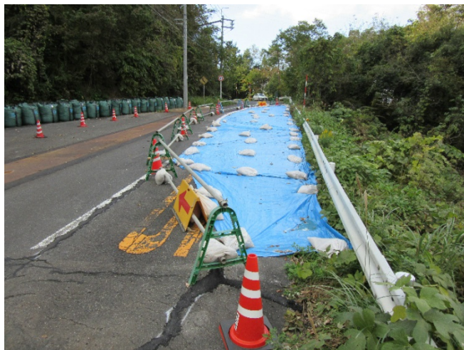
写真 2.20 ②部にみられる路面の陥没
