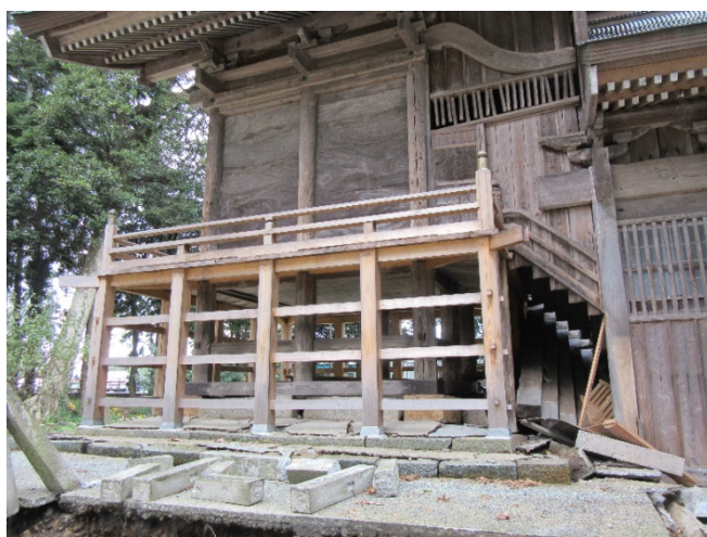
写真2.12 社殿の被害状況
