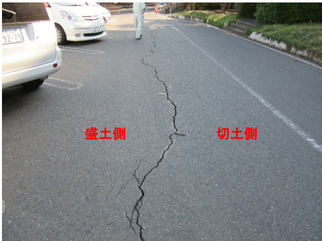
写真2.6 市役所(本庁舎)北側の地盤変状
