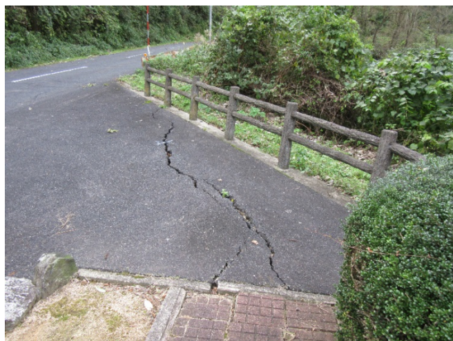
写真 2.19 ①部にみられる路面のクラック
