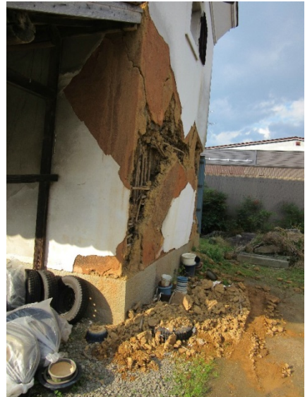
写真 2.8 土壁の大規模な剥離
