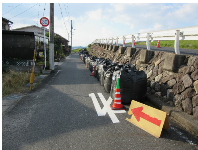
写真 2.23 石積擁壁の孕み出し
