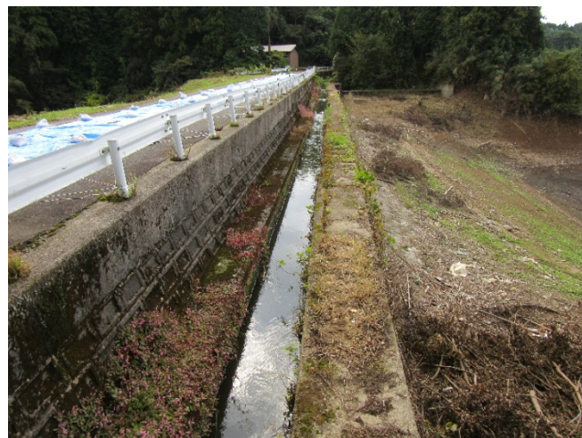
写真2.15 水路側壁のわずかな孕み出し
