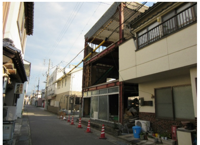
写真 2.9 3階建鉄骨住宅の壁材の欠損
