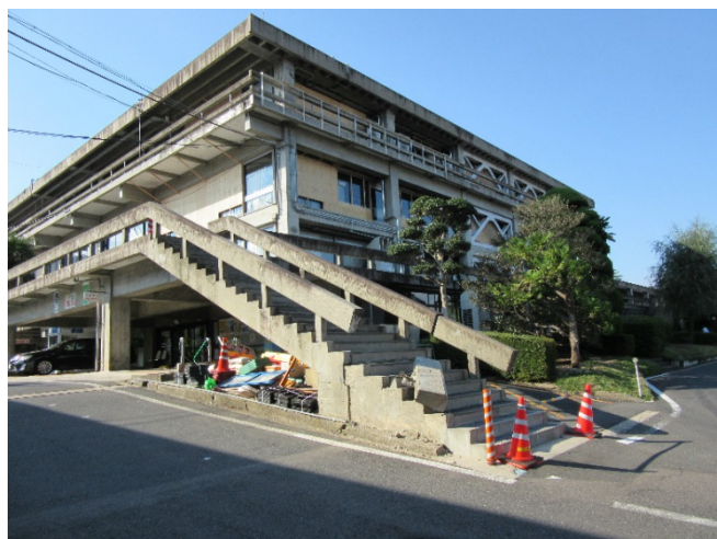
写真2.4 市役所(本庁舎)の被災状況
