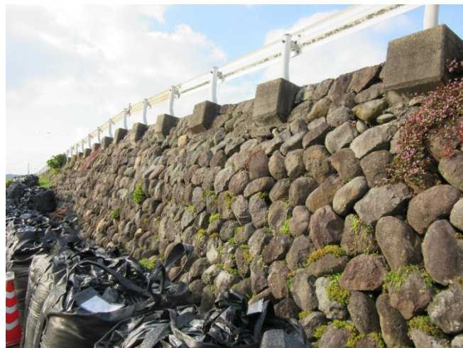
写真 2.24 石積擁壁の孕み出し
