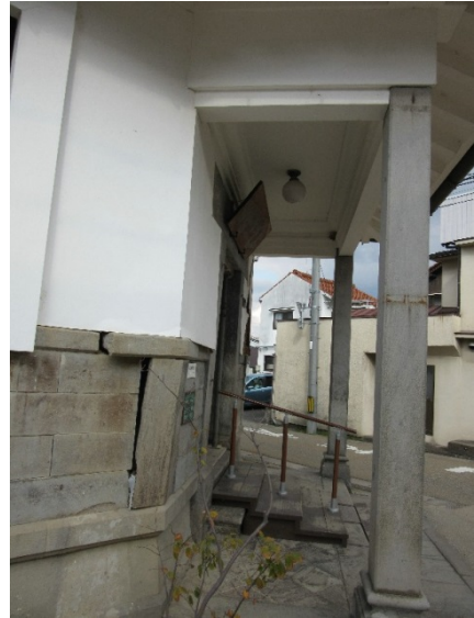
写真 2.7 土蔵の基礎石の孕み出し
