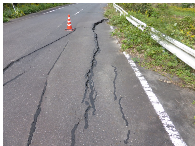
写真5.2 古い補修跡に再度変状が発生している
