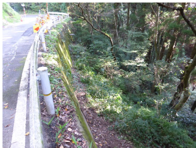
写真3.2 変状発生箇所の斜面状況
