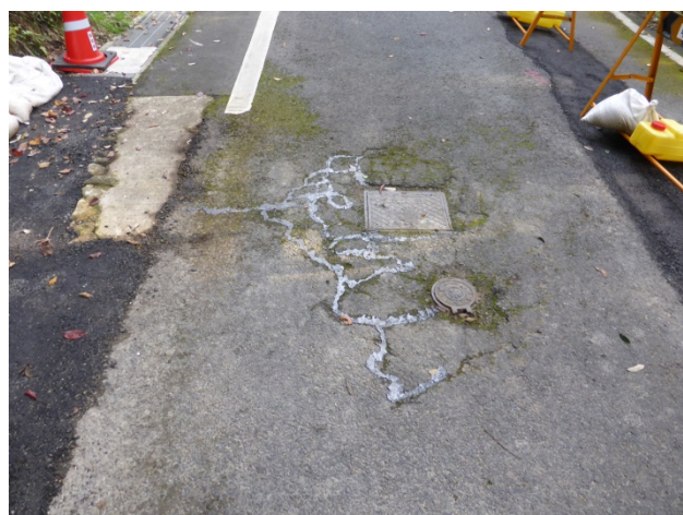
写真3.4 水道管周辺の変状
