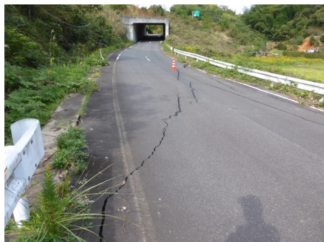
写真5.1 北上西農免道路の盛土変状
