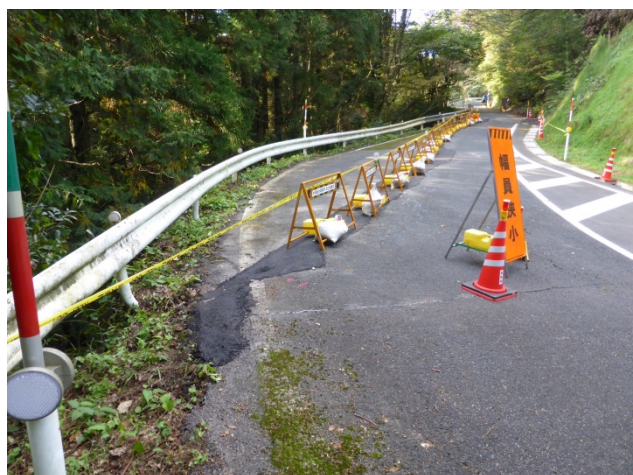
写真3.1 変状箇所全景
