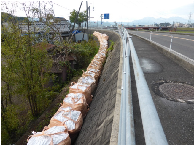
写真6.1 小鴨川3k8付近の変状
