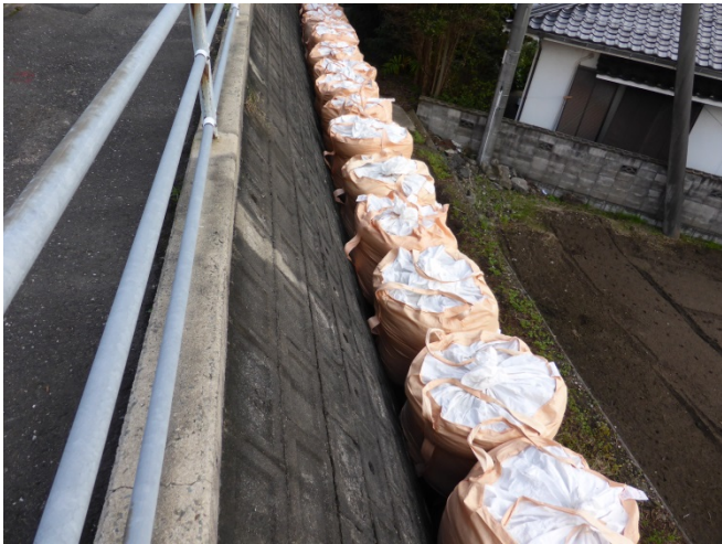
写真6.3 擁壁の孕みだし
