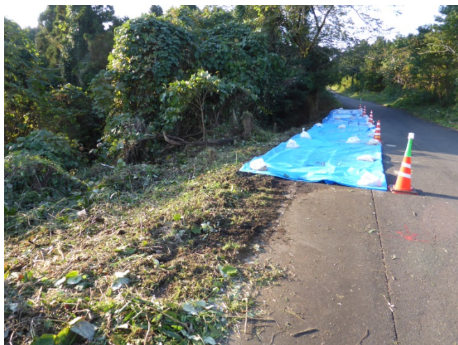
写真3.5 路側の変状発生箇所
