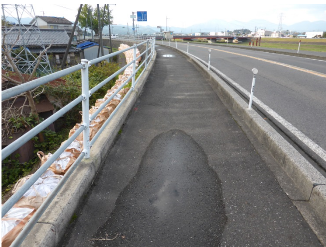
写真6.3 歩道部路面の沈下（水たまり箇所）
