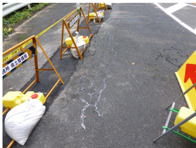
写真3.3 路面の亀甲状クラック
