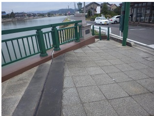
写真5.4 コナン大橋橋台背面沈下
