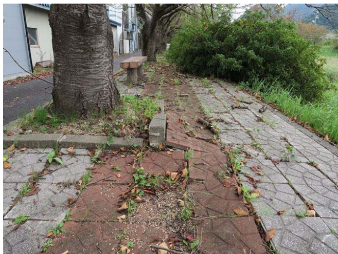
写真3.4 東郷川右岸堤防舗装タイルの変状
