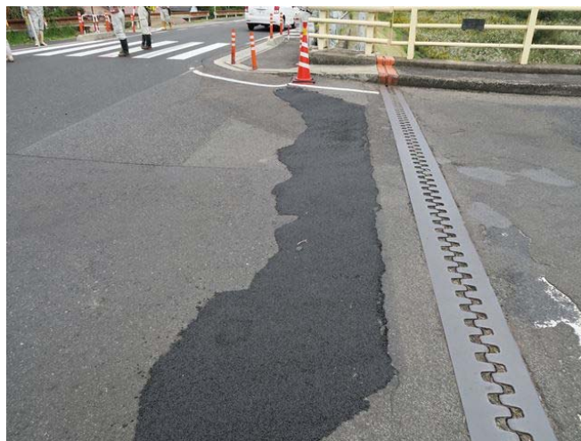
写真2.10 三明寺橋橋台背面の沈下（左岸側）
