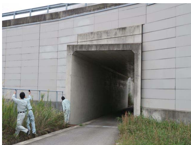
写真4.6 EPS擁壁パネルのずれ、開き
