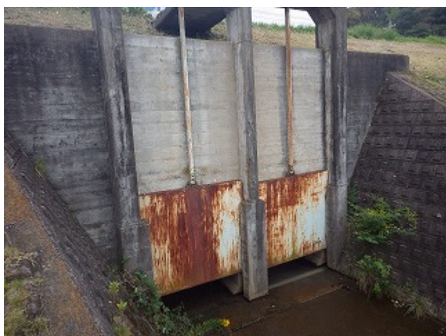
写真2.9 近傍の樋門（名称不明、損傷なし）
