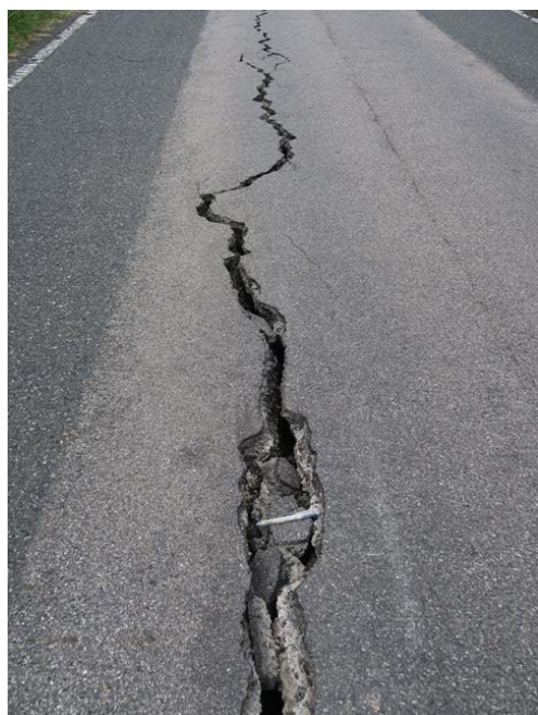
写真2.8 小鴨川左岸堤防の縦断方向クラック
