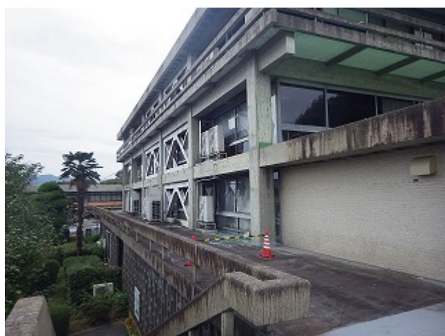
写真2.2 倉吉市役所庁舎窓ガラスの破損
