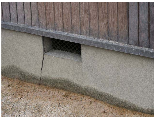
写真6.2 家屋基礎のクラック
