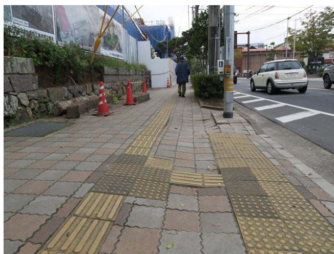
写真2.4 庁舎前歩道部の沈下
