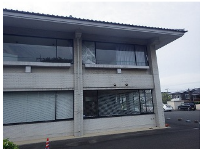
写真5.3 北栄町商工会館窓ガラスの破損
