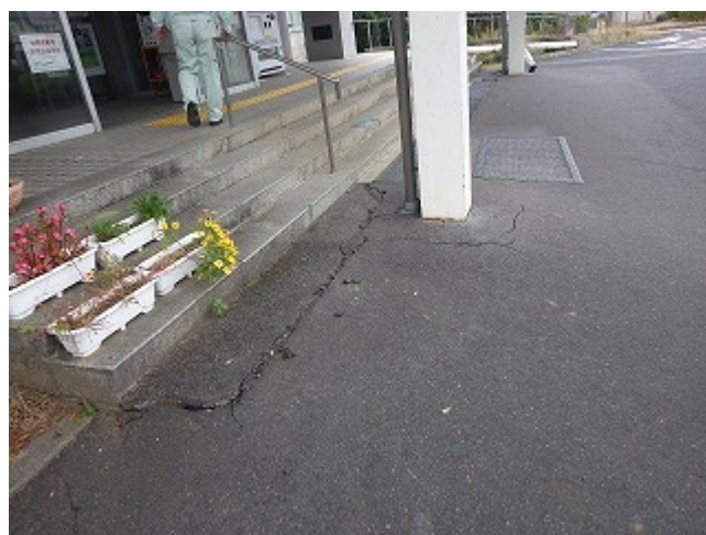
写真3.3 庁舎玄関前の沈下
