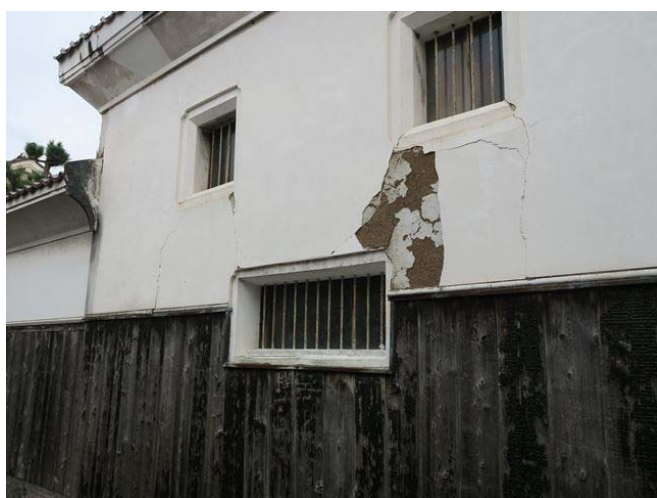
(b) 窓枠周りの亀裂およびはがれ 写真2.5 白壁土蔵群の壁の損傷
