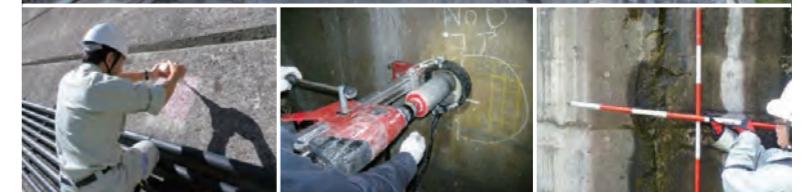
ダム点検・維持管理・長寿命化計画（左から鎌井谷ダム・矢作ダム・桐見ダム）
