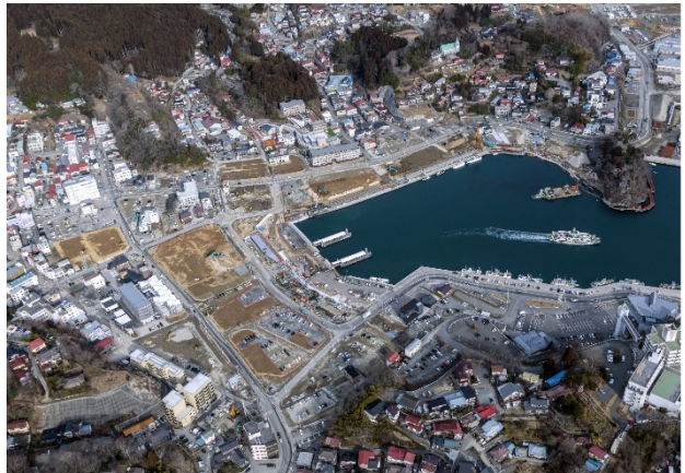
2018年1月15日撮影：建物撤去完了、盛土造成工事が実施 災害公営住宅は早々に完成
