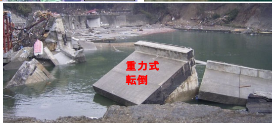
写真1 被災前後及び破堤状況(岩手県提供)
