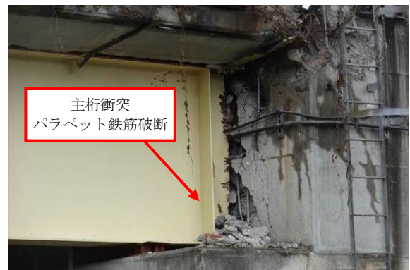
写真 4.1.7 上部工の移動による橋台の損傷
