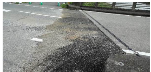
写真 4.1.22 橋台背面沈下(応急復旧済み)
