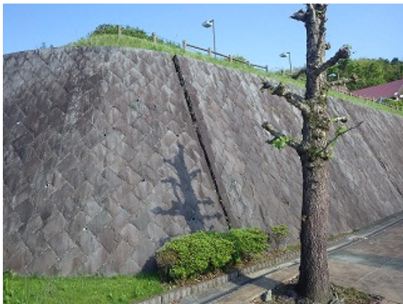
写真 8.3.3 擁壁の開き (10cm 程度)
