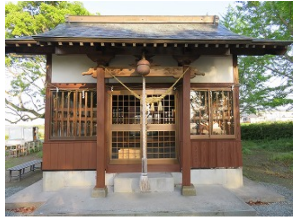
写真 8.2.11 柱のずれ (写真右)
