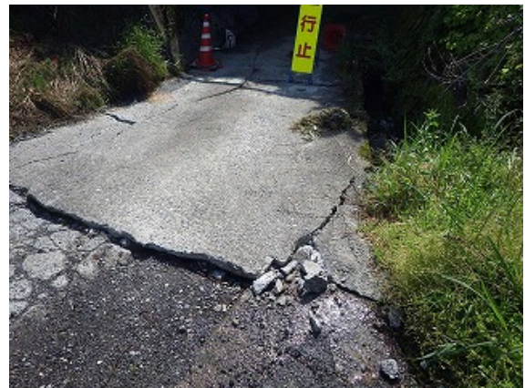
写真 8.4.2 路面のひびわれ
