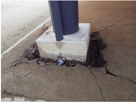
写真 8.3.2 東屋の柱基部排水孔のずれ
