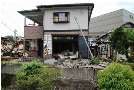
写真 9.1.2 新しい建物の被害
