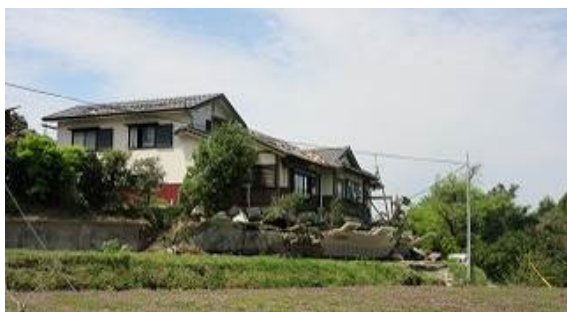
写真 8.1.2 家屋擁壁の倒壊
