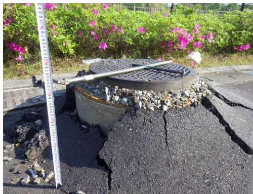
写真 7.2.2 マンホールの浮上(2)
