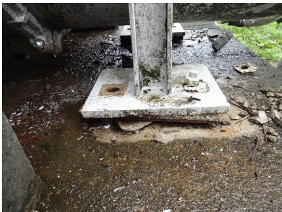
写真 7.1.6 ボルトの破断と支承のずれ
