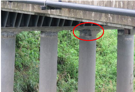
写真 4.1.29 柱頭部被りコンクリート剥離
