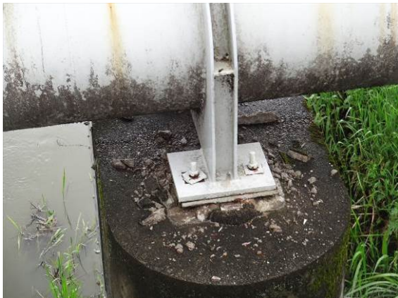
写真 7.1.5 台座コンクリートの破損
