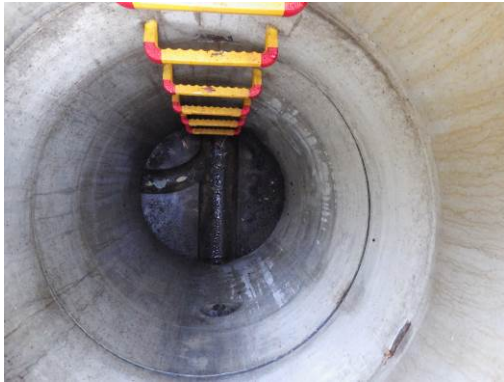
写真 7.2.10 浮上したマンホール内部(2)
