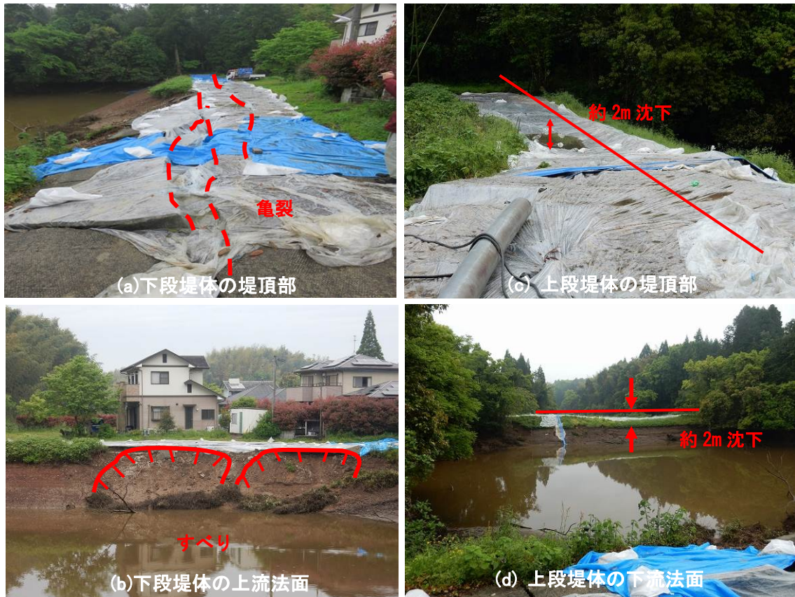
写真 7.3.6 陳内地区ため池の被害状況
