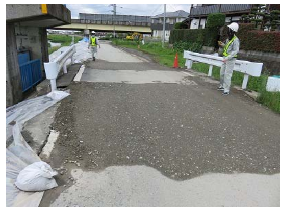
写真 5.3.1 秋津川堤防と樋管の段差被害
