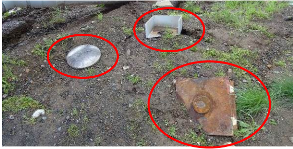
写真 4.1.9 支承の損傷(脱落した部材)
