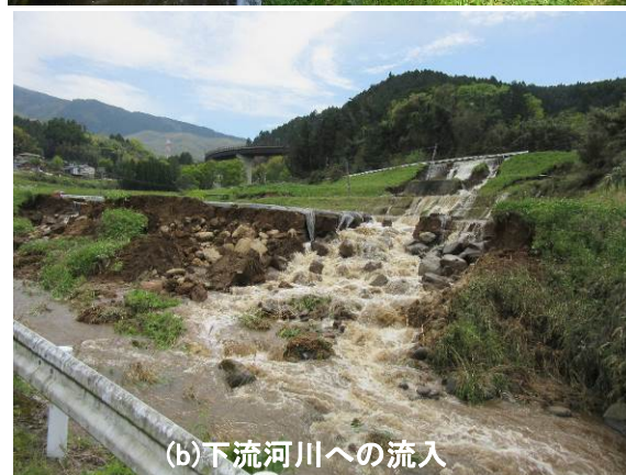
写真 7.3.4 下流分水工(調整池)の被害状況
