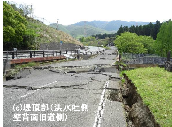
写真 7.3.1 上流面及び堤頂部の被害状況
