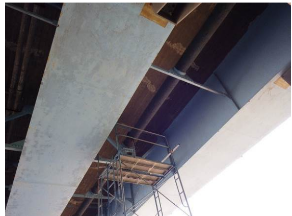
写真 7.1.7 添架管の漏水 (1)
