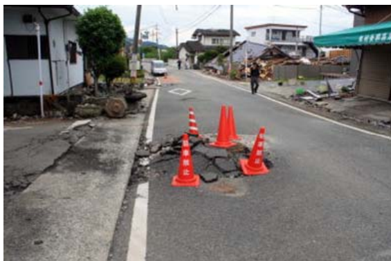
写真 8.1.4 マンホールの浮き上がり (4/26)
