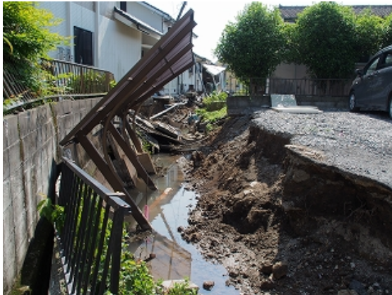
写真 3.3.3 沼山津地区の小河川の護岸崩壊
