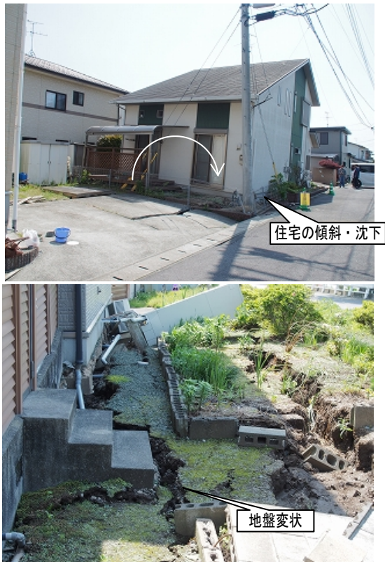
写真 3.2.5 住宅の傾斜・沈下、地盤変状(秋津町)
