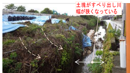
写真 4.3.17 すべり崩壊箇所の現地写真(2)
