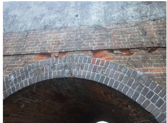
写真 8.4.1 レンガの剥落
