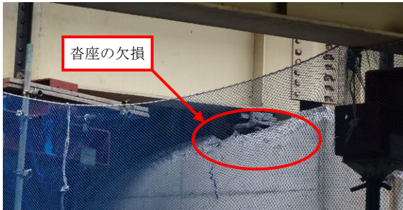
写真 4.1.10 沓座のコンクリート欠損
