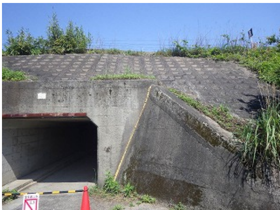
写真 8.4.4 上部盛土のはらみ出し
