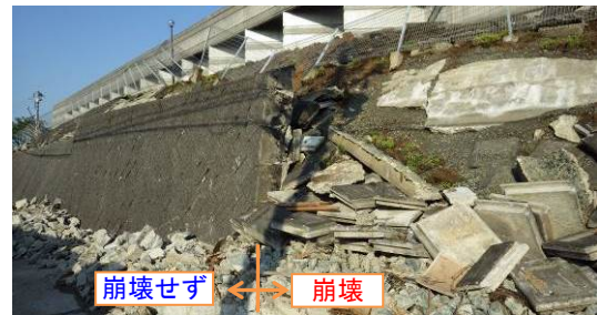
写真 4.3.13 崩壊・非崩壊箇所が連続する擁壁 4.3.7 寺迫交差点付近(北側)の擁壁を含む 斜面の崩壊
