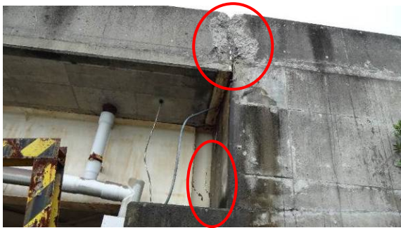
写真 4.1.16 主桁と橋台部の地覆衝突
