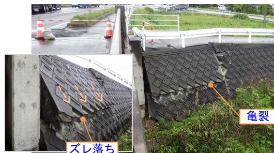
写真 4.3.2 ブロック積み護岸の変状(新木山橋)
