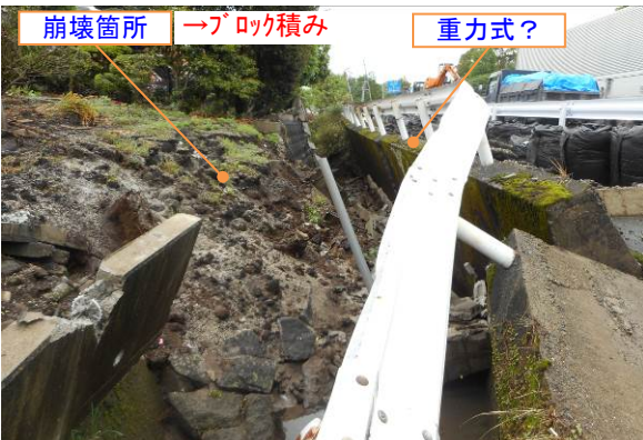
写真 4.3.6 重力式擁壁の変状とブロック積みの崩壊
