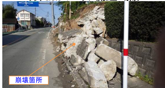
写真 4.3.10 ブロック積擁壁の崩壊
