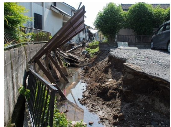
写真 5.4.2 重力式護岸の倒壊
