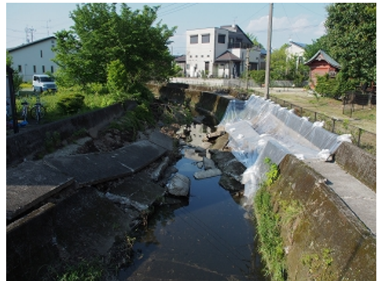
写真 5.4.1 重力式護岸の倒壊
