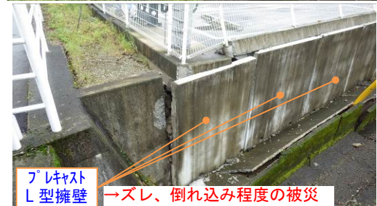
写真 4.3.7 プレキャストL型擁壁の変状
