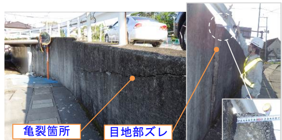
写真 4.3.8 現場打ち直擁壁の変状・損傷
