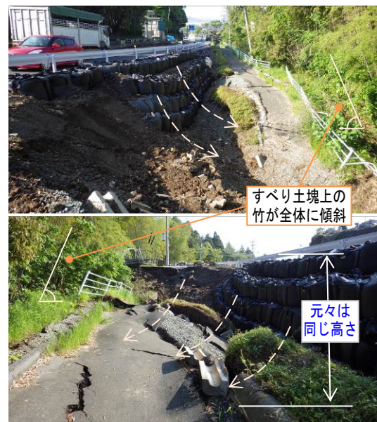
写真 4.3.14 土工部のすべり破壊
