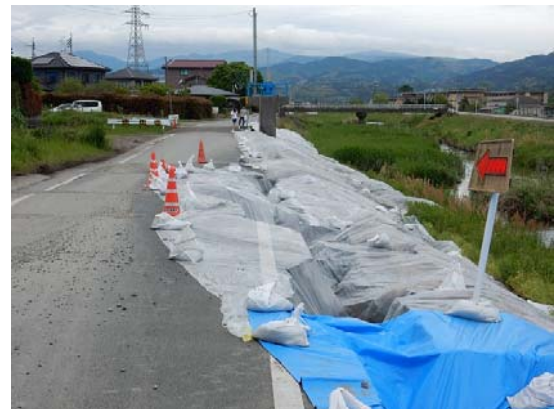
写真 5.2.1 秋津川堤防の被害状況
