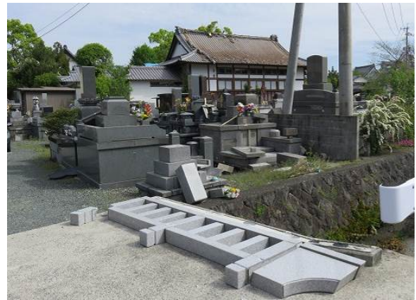
写真 8.2.2 本堂の屋根および燈籠の被害
