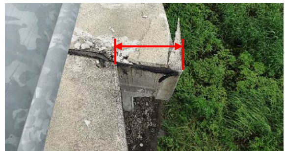
写真 4.1.14 上部工の移動と地覆側面の剥離
