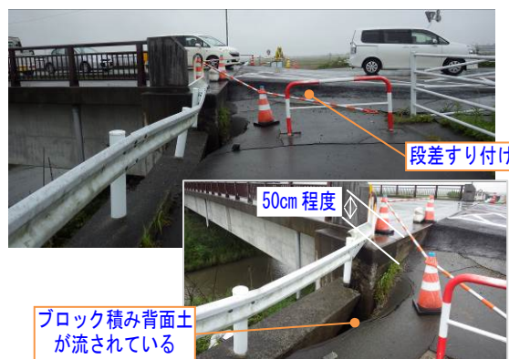
写真 4.3.3 橋台背面の段差(新木山橋)
