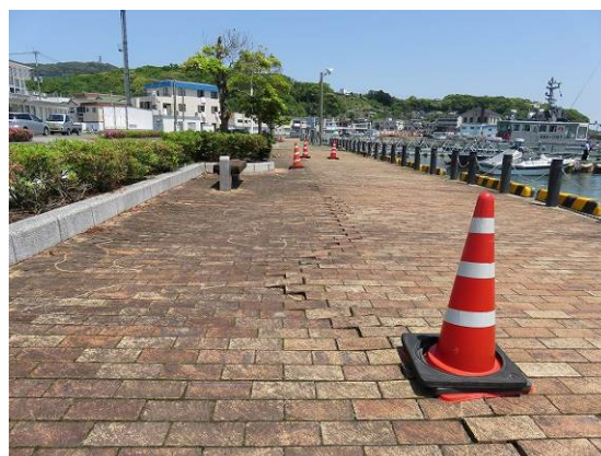
写真 6.2.3 岸壁背面の不陸
