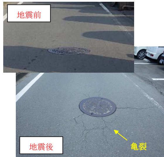
写真 7.2.12 浮上診断マンホールの舗装亀裂
