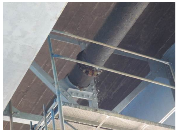
写真 7.1.8 添架管の漏水 (2)
