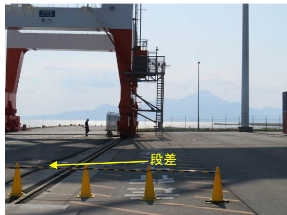
写真 6.4.2 レール基礎の沈下
