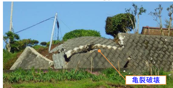
写真 4.3.11 ブロック積擁壁の亀裂破壊
