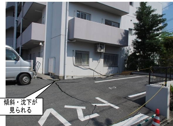
写真 3.3.2 傾斜・沈下したマンションと変状(沼山津)
