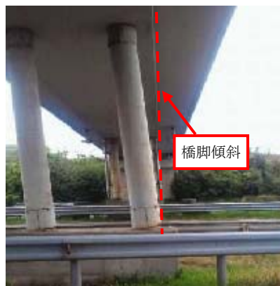
写真 4.1.2 橋脚傾斜状況(国交省 HP より)
