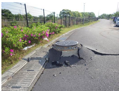
写真 7.2.1 マンホールの浮上(1)
