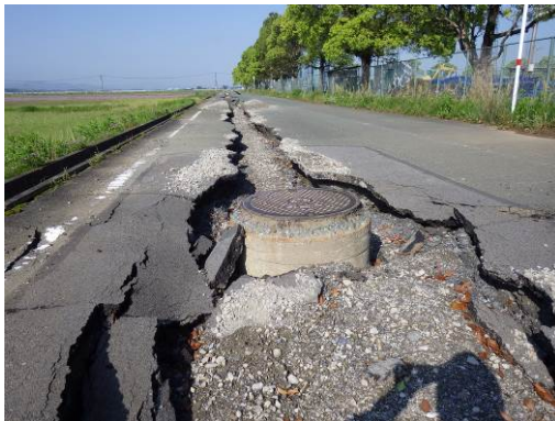
写真 7.2.5 開削部の道路陥没 (2)
