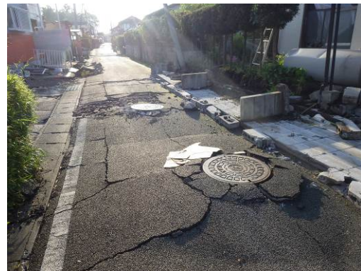
写真 7.2.7 マンホール及び周辺舗装の被害
