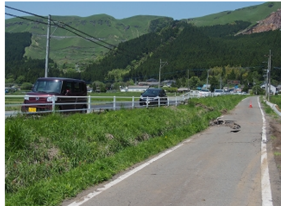
写真 10.3.5 阿蘇市無田 (赤水駅付近) で見られた地割れ(2)
