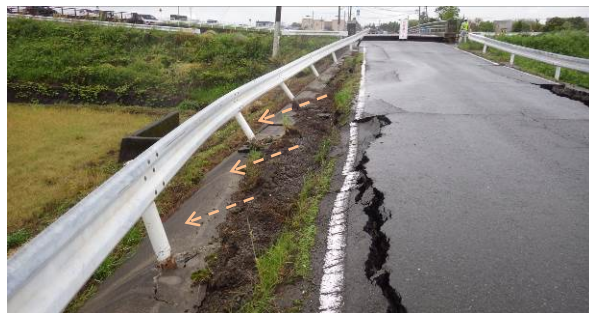
写真 4.3.1 取付盛土の変状(第一畑中橋)
