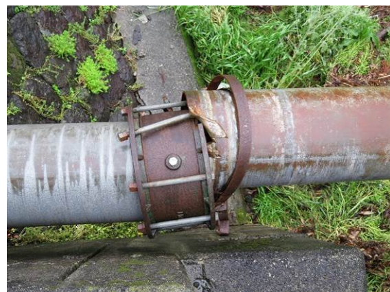
写真 7.1.3 継手の損傷状況
