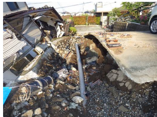
写真 7.2.8 露出した宅内配管
