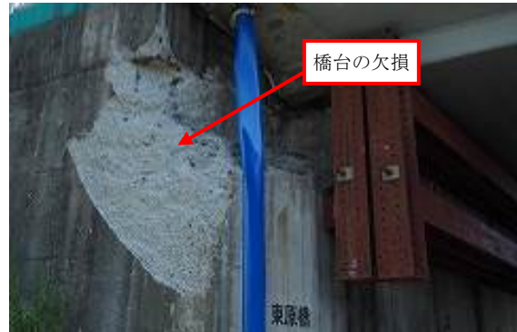
写真 4.1.32 橋台沓座の欠損
