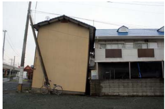
写真 8.1.5 液状化による住宅被害 (4/25)
