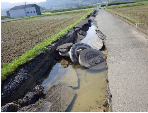
写真 7.2.4 開削部の道路陥没 (1)
