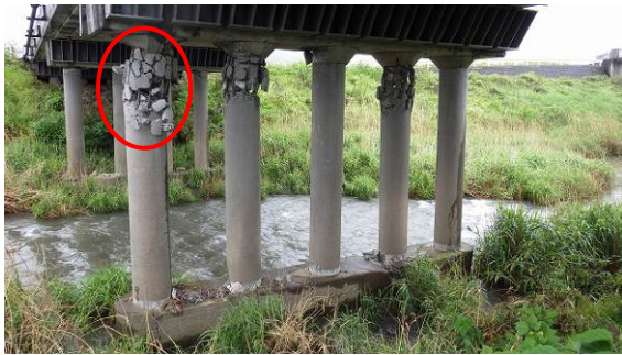
写真 4.1.28 柱頭部のせん断破壊
