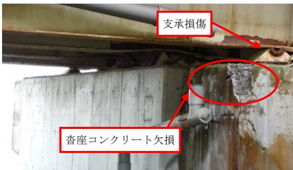
写真 4.1.18 支承の損傷と沓座の欠損
