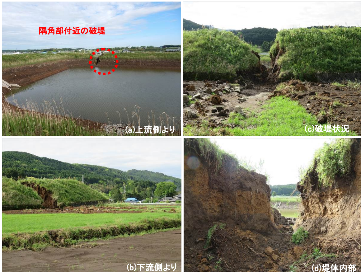
写真 7.3.5 下小森地区ため池の被害状況
