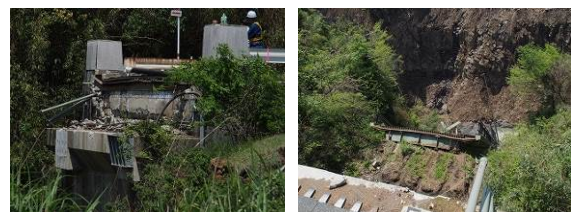
写真 10.2.3 阿蘇大橋 左:橋台 右:橋台から見下ろした桁
