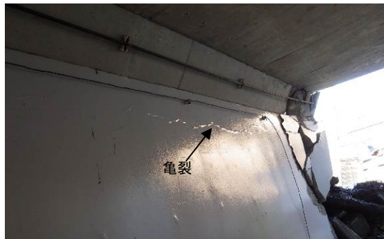
(b) 側壁上側隅角部の亀裂
