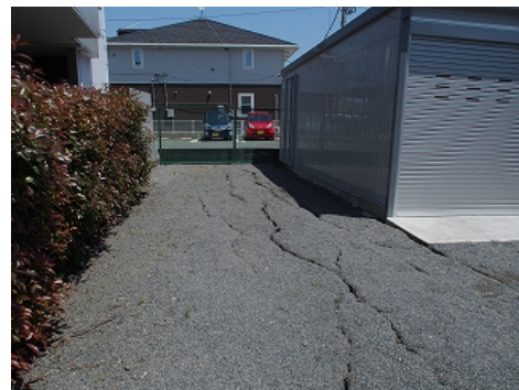
写真 3.2.1 ビルの傾斜，地割れ（西熊本駅周辺）
