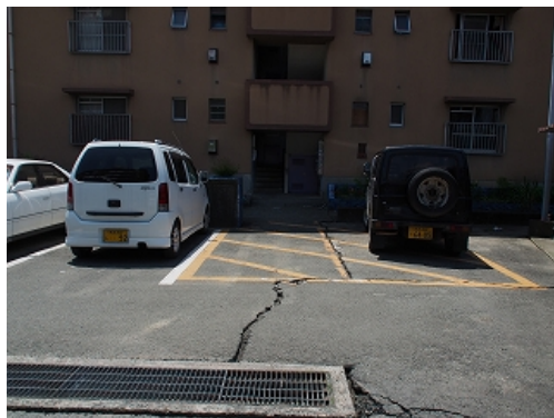
写真 3.2.3 地割れとアパート周辺地盤の沈下（西熊本駅周辺）
