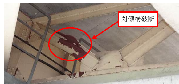
写真 4.1.8 対傾構の座屈
