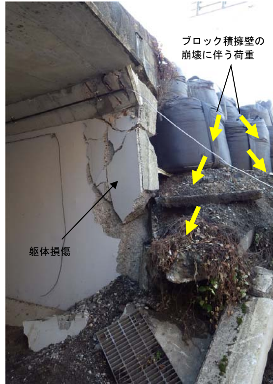
(c) 西側坑口部の被害
