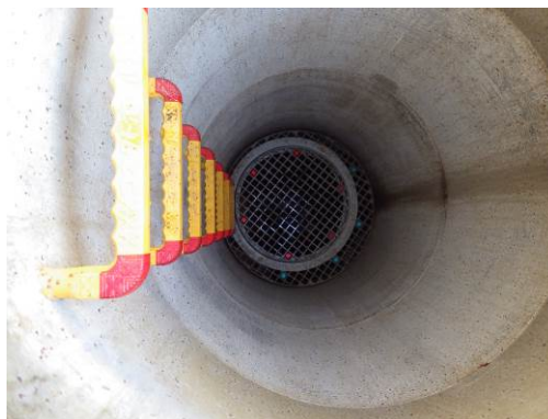
写真 7.2.3 浮上したマンホール内部(1)
