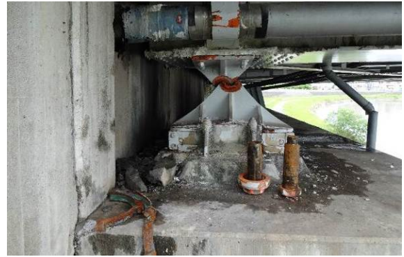
写真 4.1.26 支承損傷状況(ピン破断)
