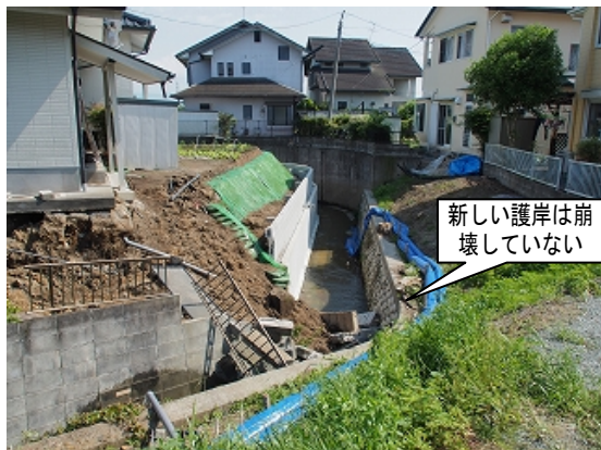
写真 3.3.4 沼山津地区の小河川の護岸崩壊
