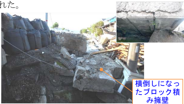
写真 4.3.5 横倒しとなったブロック積み擁壁
