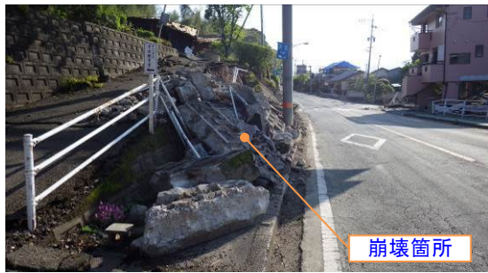
写真 4.3.9 ブロック積擁壁の崩壊
