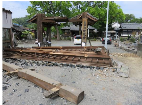
写真 8.2.1 門の屋根の落下
