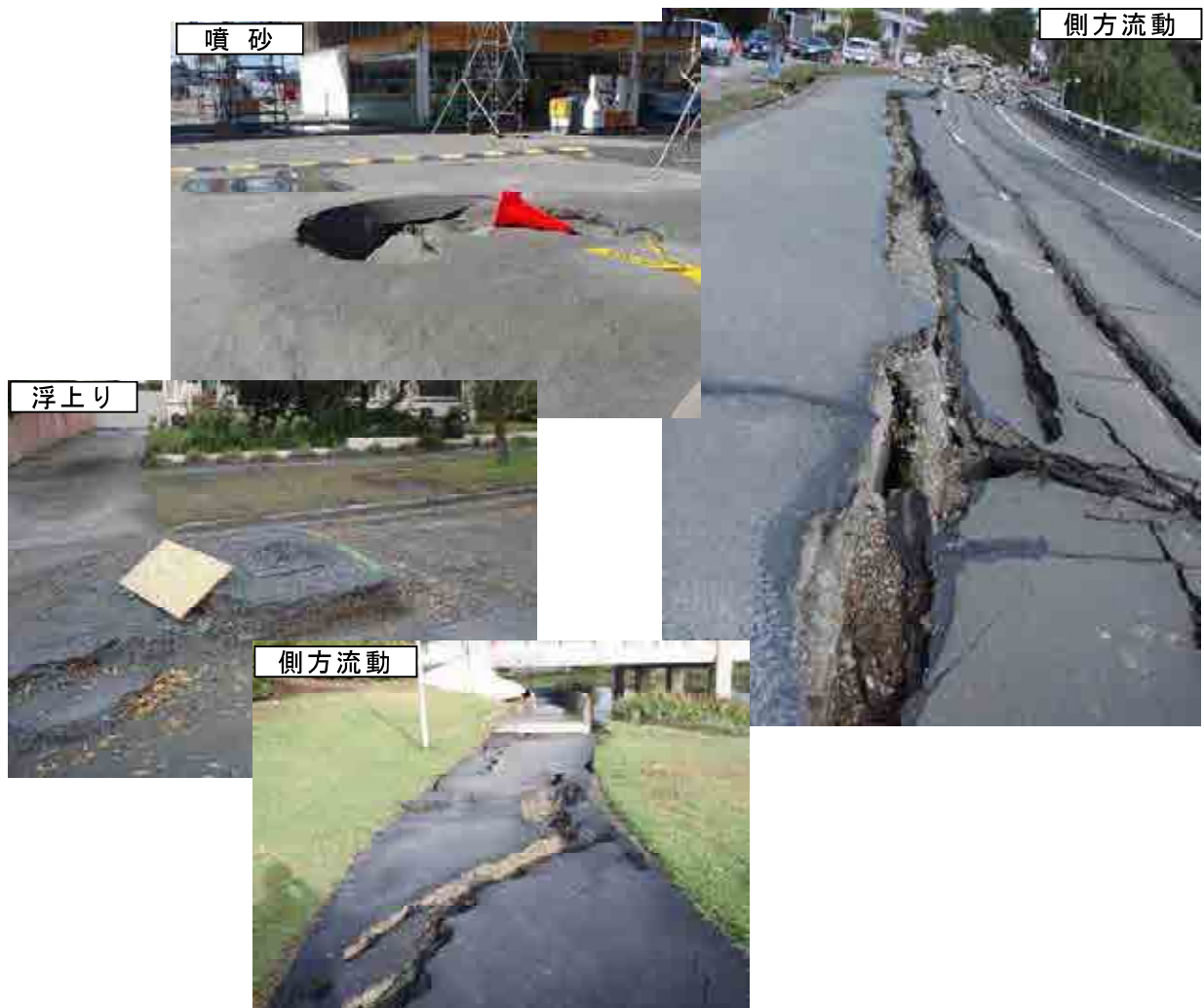
写真-5.1.1 噴砂・側方流動・浮上り等の発生状況
