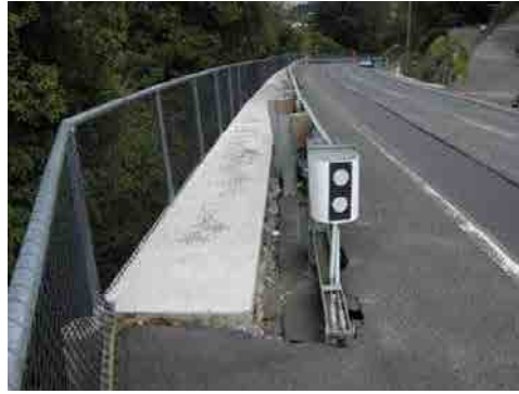
フトンカゴの傾動に起因した路側変状
