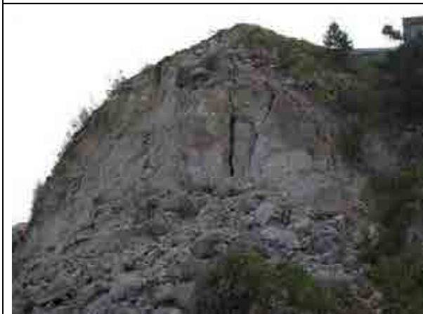
崩壊跡には開口亀裂が認められ、非常に不安定。
