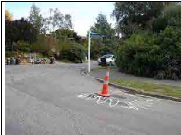
13 斜面上のマンホールの浮き上がり。斜面傾斜は 10° 程度である。周辺の変状は極めて軽微である。
