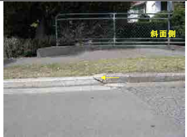
16 水路ボックス周辺に圧縮変状が発生している。相対的に斜面側が乗り上げている。
