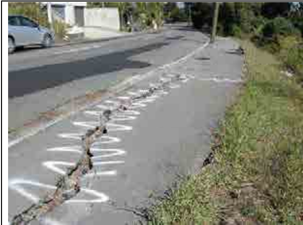
19 歩道部の地すべりの変状。
