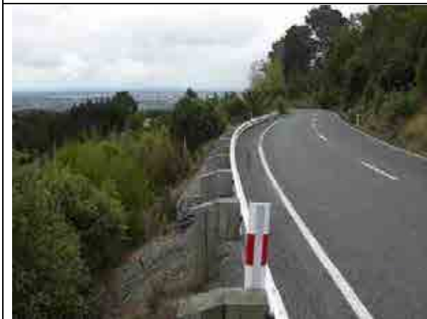
3 路側の盛土フトンカゴの変状
