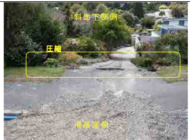
8 滑落崖下方。勾配変化点付近で圧縮変状が認められ、土塊の滑動を示唆している。
