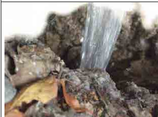
11 調査時点では水道の破断により水が絶えず供給されていた。
