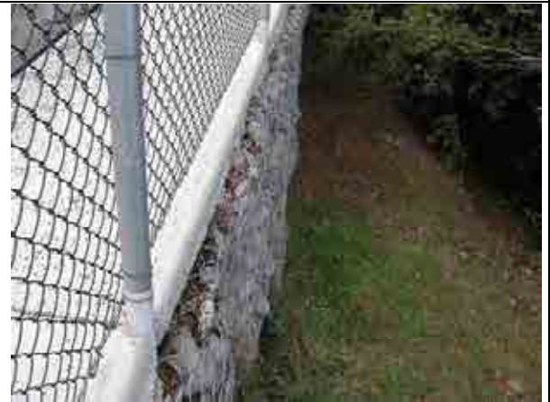
10 歩道部はフトンカゴを垂直に積み上げて構築されている。舗装部に変状が見られるがフトンカゴの変状は極軽微である。
