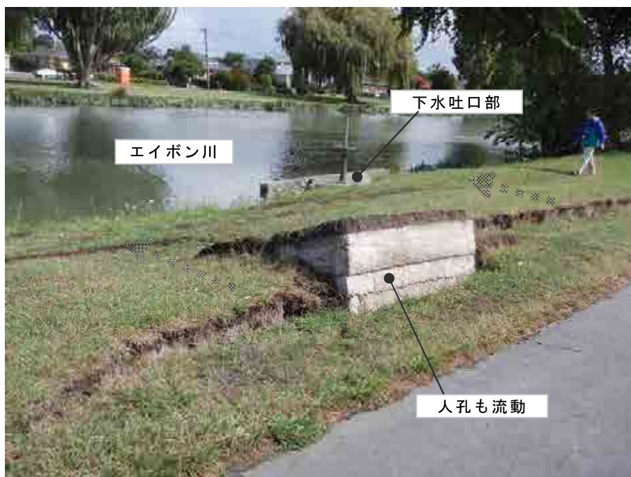
写真-5. 3. 6 川岸の側方流動発生状況 (2)
