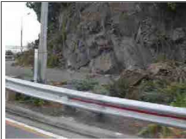
硬質な玄武岩溶岩の崩壊。径 1m 程度の落石が多い。
