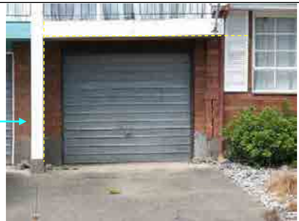
20 写真 19 の家屋変状
