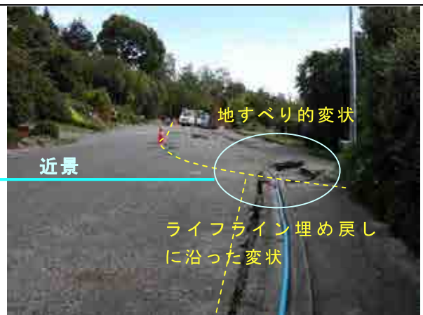
6 同左。直線的な滑落崖を形成しており、この付近ではライフラインの埋め戻しに沿って滑動した可能性がある。
