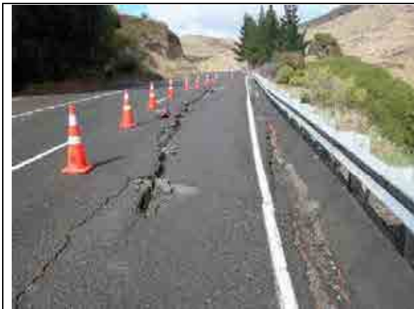
1 EvavsPass Rd.の変状。切盛境で盛土側が不安定化している。浅い谷地形を盛土している。
