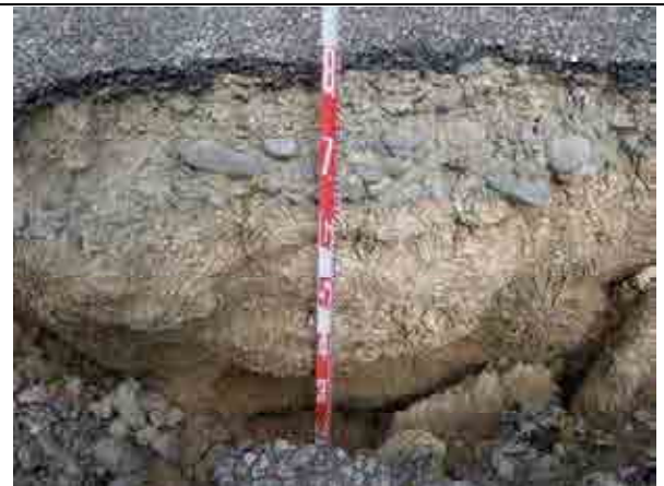
10 最大滑落落差 0.8m。15cm 程度の路盤の下は古い盛土もしくは自然地盤である。
