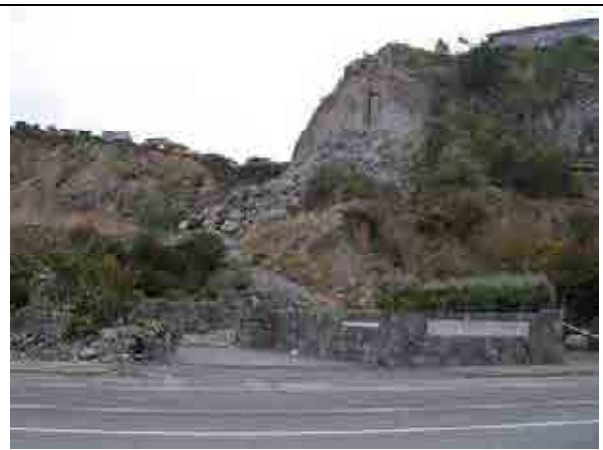
凝灰角礫岩の岩盤崩壊。
