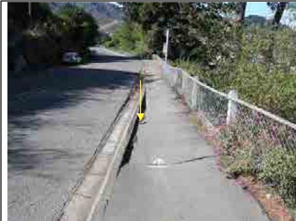
25 歩道部と車道部の境界に発生した変状。この付近ではフトンカゴが施工されている。相対的に山側が沈下しており滑動傾向にある。
