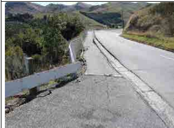
17 写真 16 に続く歩道部の変状。
