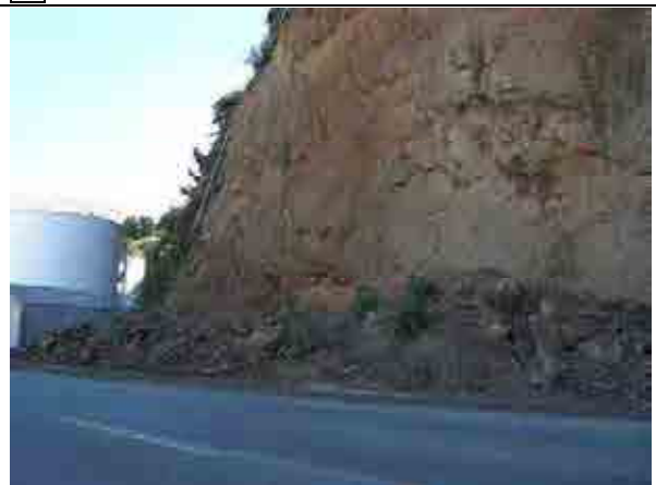
30 写真 29 の斜面。表層の剥離が多発している。大規模な土塊の不安定化は認められない。
