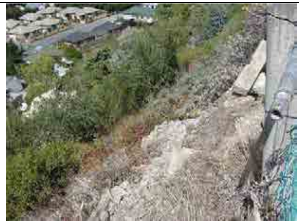
24 井桁擁壁の間詰土の流出。主に砂礫で間詰されており、粒径が細かいため、流出しやすい。
