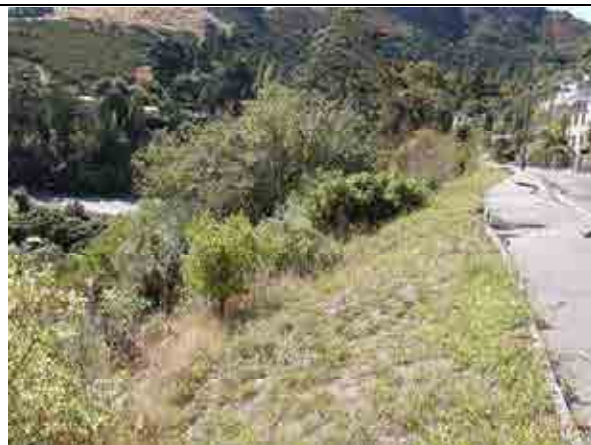
23 写真 19 の被災箇所の斜面状況。40° 程度の自然斜面が続いており構造物はない。
