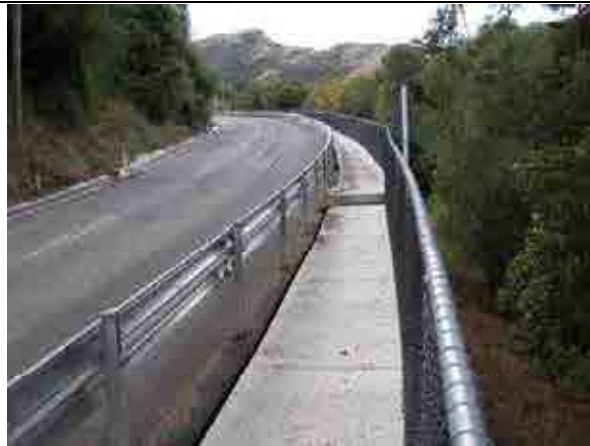
9 歩道部と車道部の剥離変状。車道部にはオーバーレイの跡があり歩道も新しいことから 2010 年の地震による被害箇所の可能性がある。
