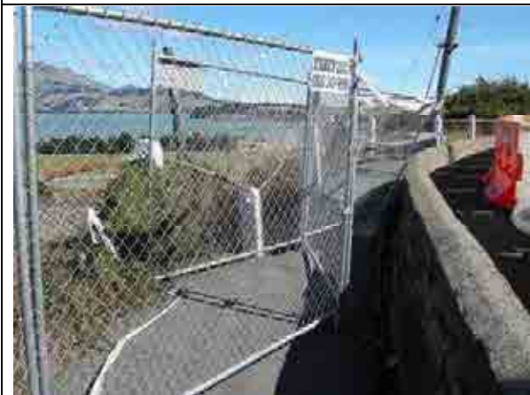
27 写真 26 の滑落箇所。
