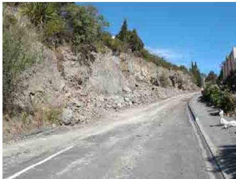
切土のり面の崩壊
