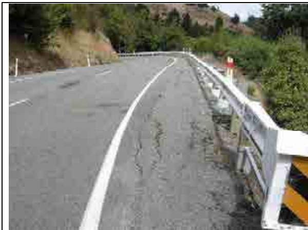
1 路側の不安定化。盛土フトンカゴの変状である。
