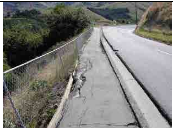
18 同左。歩道部と車道部の境界付近に変状が集中している。切盛境と思われる。
