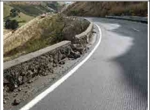
4 落石によると思われる転落防止擁壁の破損。
