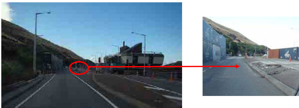
図-8.1.3 リテルトンロードトンネルのクライストチャーチ側手前の道路損傷状況
