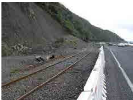
SH1 の斜面崩壊箇所（復旧済み）
