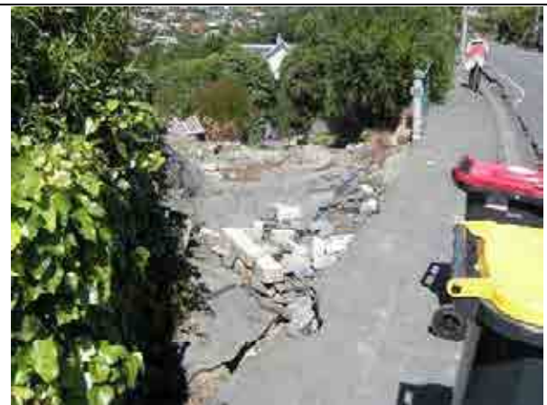
22 Glenstrae Rd.の盛土部の変状。写真 21 と同一箇所。50cm 以上の落差が生じている。
