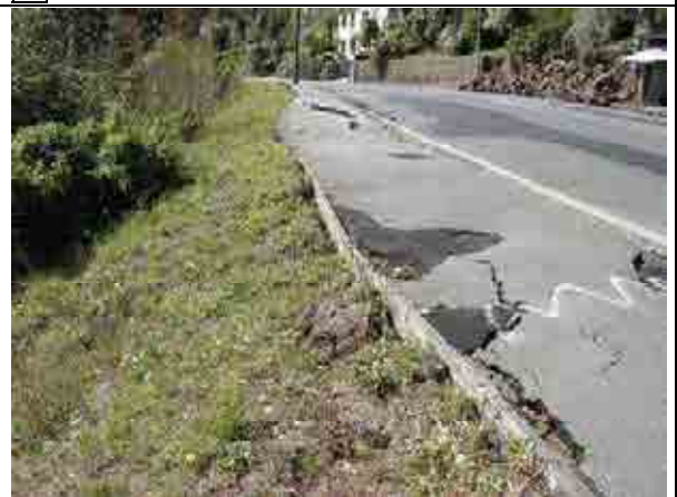
22 同左。車道部、歩道部にパッチの跡があり、2010 年の地震災害箇所の可能性がある。
