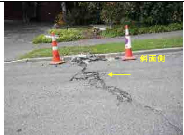
22 路面の圧縮変状。相対的に斜面側が乗り上げている。
