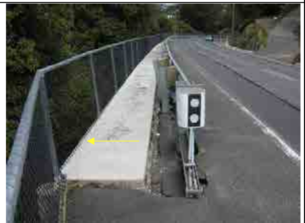
12 同上。歩道部の山側が相対的に持ち上がっておりフトンカゴは転倒傾向にある。
