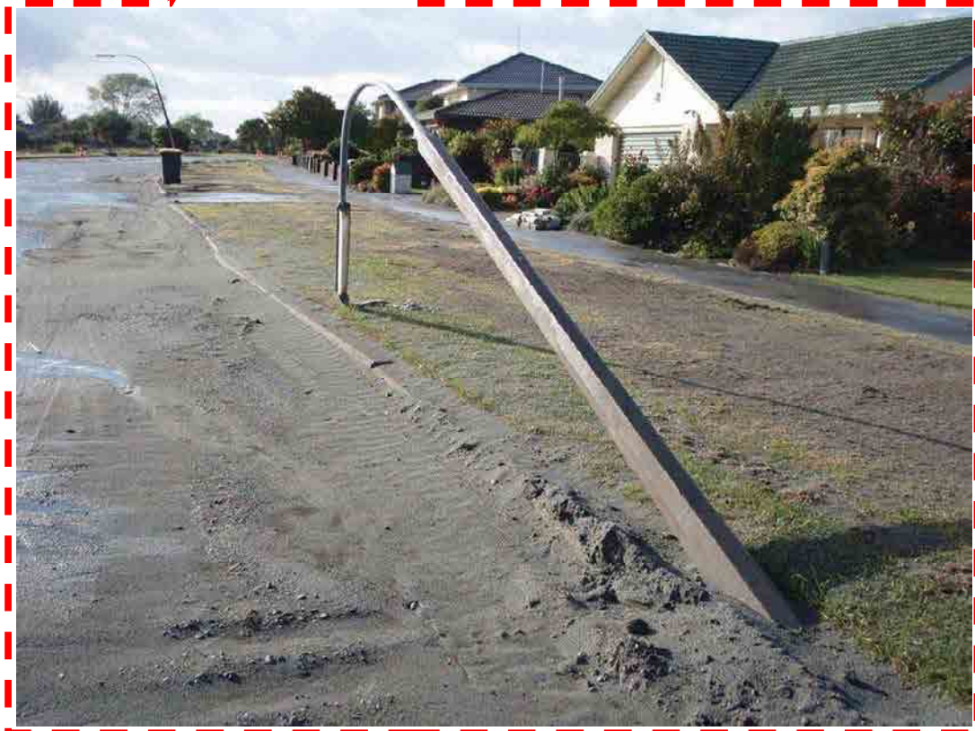
図-8.3.4 河川沿い住宅街路の被害
