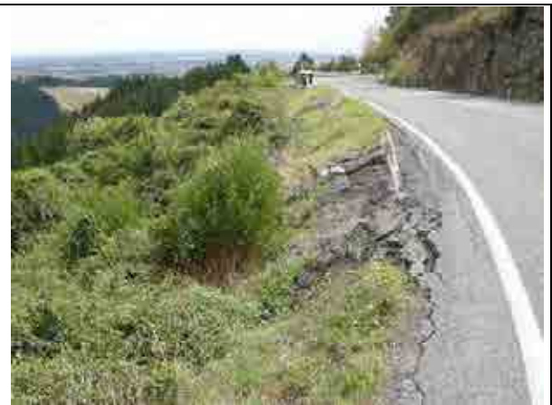
2 路側の不安定化。構造物はなく極表層が滑動している。
