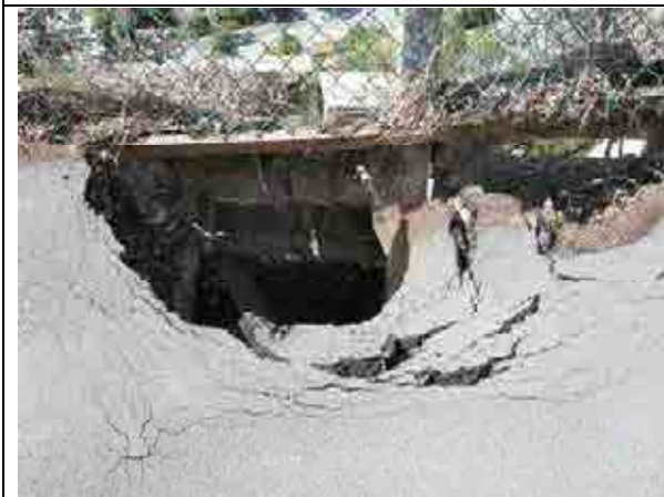
23 写真 21 の井桁擁壁。間詰土が流出し、陥没している。変状形態からみると、水の影響があった可能性がある。
