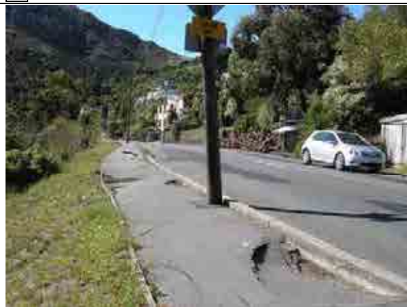
21 写真 19 と同一箇所。歩道部に陥没変状が認められる。マンホールなどのライフラインは確認できなかったが、吸出しが発生している可能性がある。
