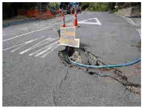
2 頭部滑落崖近景
