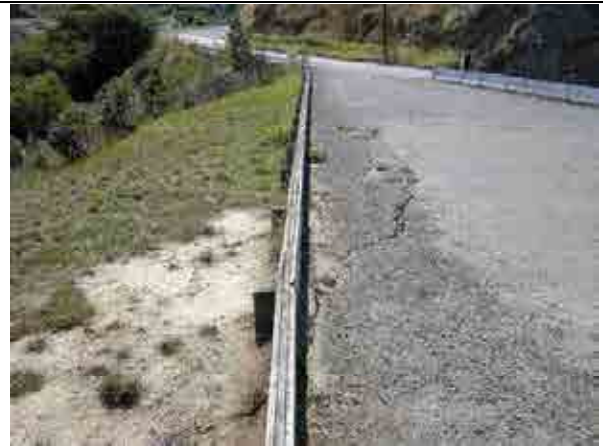
16 駐車帯の変状。切盛境に発生した変状の可能性がある。
