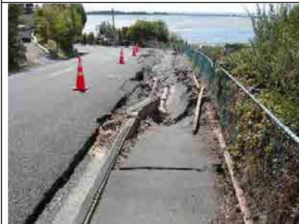
21 Glenstrae Rd.の盛土部の変状。陥没地形が形成されており円弧的なすべりが発生している。変状発生箇所には水道管が敷設されており、埋め戻し土を中心に変状が発生しているようである。
