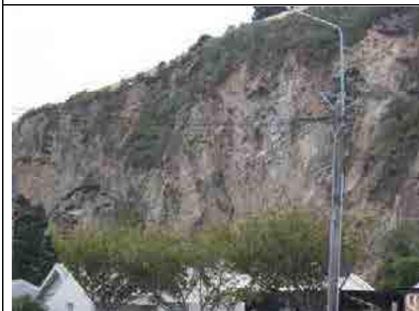
ほぼ垂直の斜面。開口亀裂が認められ、今後の余震や降雨によるトップリング的崩壊が懸念される。
