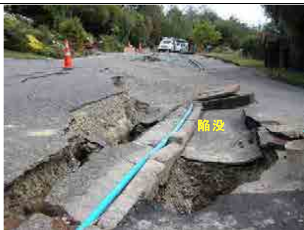
5 頭部滑落崖 落差 0.5~0.7m。写真 6 の地すべりの変状境界の近景。ライフラインの埋め戻し土の流出のためか陥没地形を示す。この付近では 0.3~0.5m 程度の水平移動も見られる。
