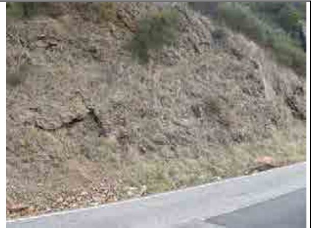
8 写真 5 の山側斜面。小規模な落石が発生しており、のり面に緩みが認められる。
