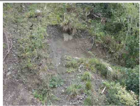
写真-6.3.9. 崩壊部周辺の比較的新しい表層崩壊。地表水、地下水が豊富で地震後の降雨で発生したものと想定される。露岩はなく厚い崩土が堆積しているようで過去に繰り返し崩壊が発生したことを示唆する。
