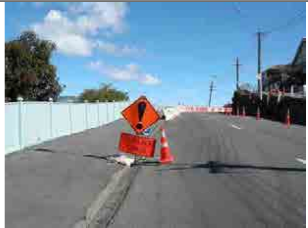
26 尾根先端部の被災箇所。
