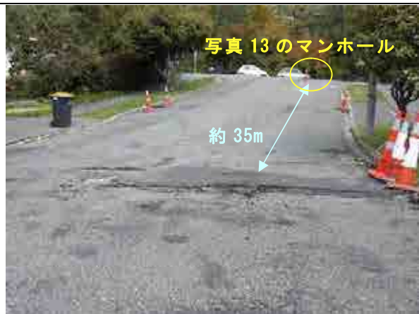
21 路面の圧縮変状
