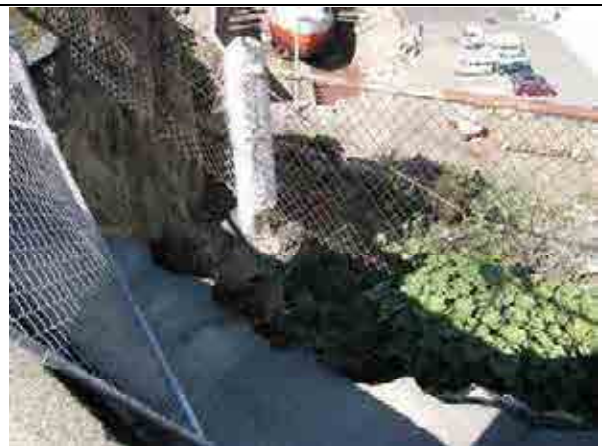
28 滑落箇所近景。
