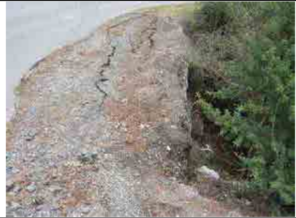
20 写真 19 の盛土構造物もフトンカゴ。かなり急斜面に盛土されており、フトンカゴの滑動が主な被災要因と考えられる。
