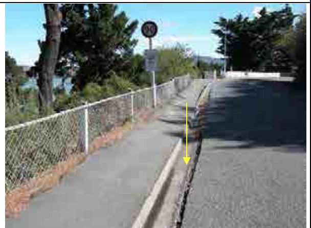
24 同様の歩道部と車道部の境界に発生した変状。
