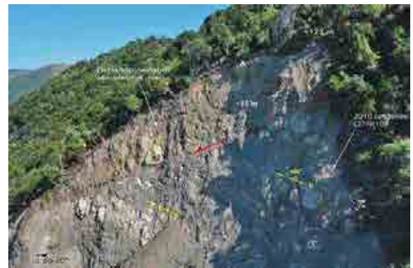
写真-6.3.4 崩壊頭部 写真上部は古い地すべり性堆積物 [3]
