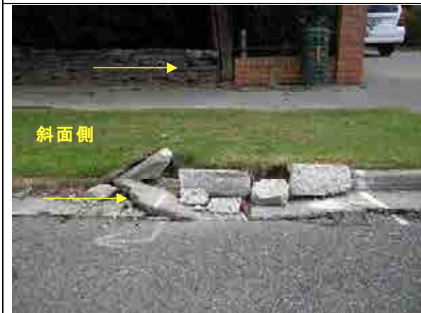
17 顕著な圧縮変状。写真奥の家屋の柱も傾動している。
