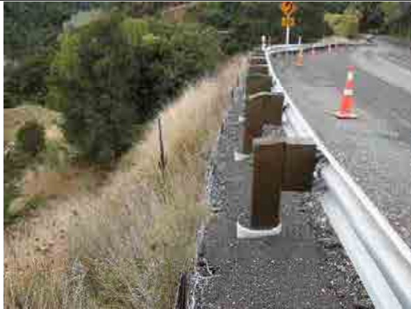
写真-6.3.13 谷側盛土。フトンカゴをほぼ垂直に積み重ねている。変状は認められない。
