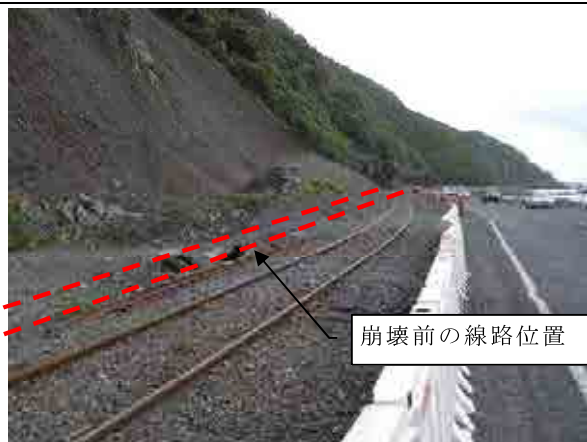
写真-6.3.8. 斜面末端部の処理。崩土による土堤とバリケードのみの対応。線路は2m程度写真右側に移設。
