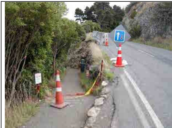
31 石積み擁壁の倒壊。幅 15m 程度。
