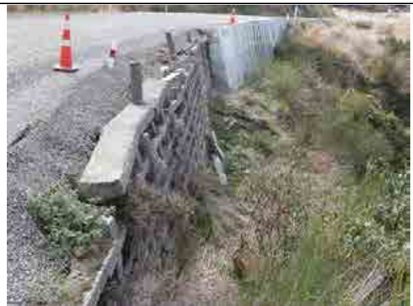
14 コンクリート擁壁に変状はないが、井桁擁壁は部材が破断し、不安定化している。
