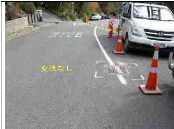
7 写真 2 の滑落崖背後の路面。全く変状は認められない。
