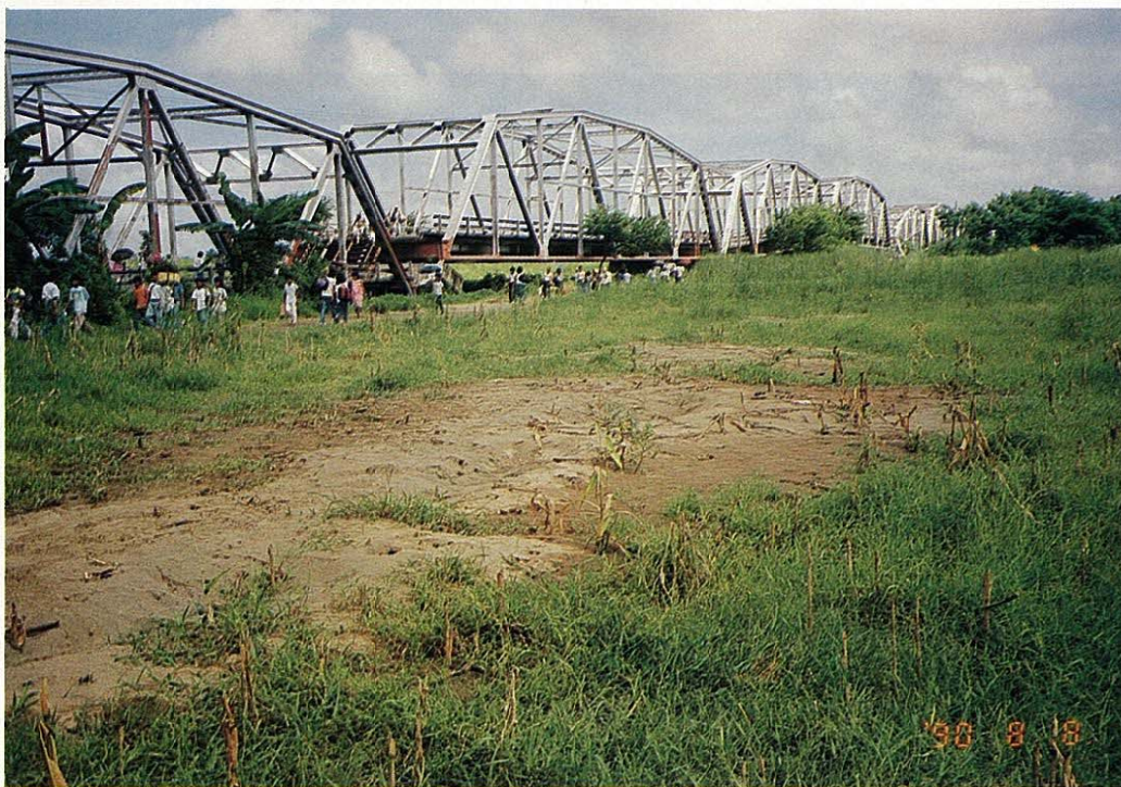
口絵写真-3 カルメン橋の落橋 — 左岸側河川敷部分の6 スパンが落橋 (手前に噴砂が見える)
