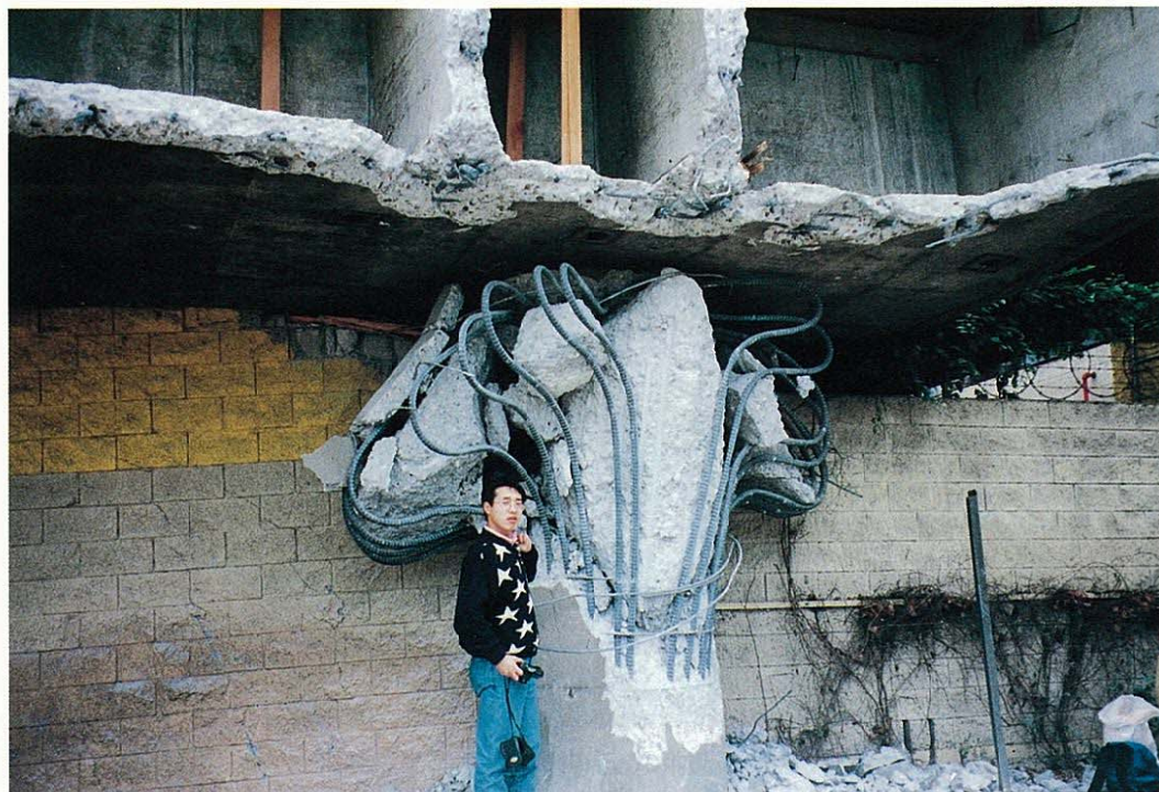
口絵写真-1 10号線（サンタモニカフリーウェイ）における高架橋の被害
