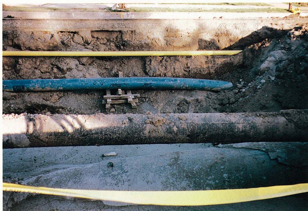
口絵写真-2 バルボア通りの埋設管の被害
