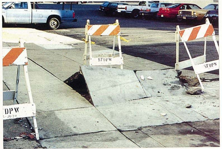
写真-6 (上) サウスマーケット地区の歩道の変状 —— 写真-3と同様の変状
