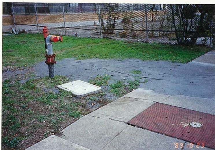
写真-16 (左) リッチモンド工業団地の噴砂 —— 工場の前庭。左手の地中には地下タンクがあり、 端辺に沿って地盤の亀裂が見られた。
