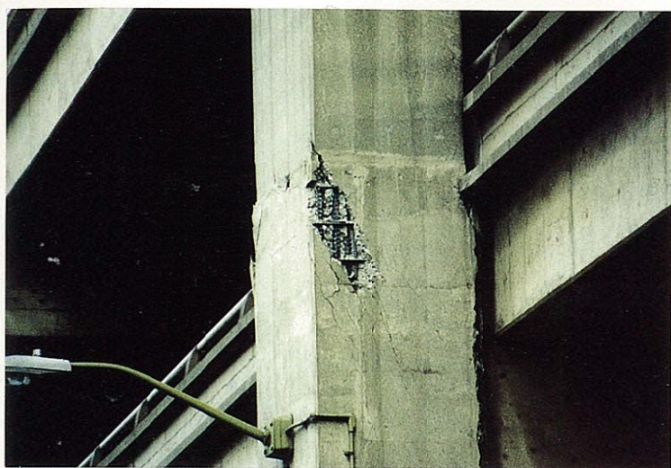
写真-32 (左) S-480 —— 橋脚の亀裂。1階上部がヒンジであるか否かは定かでない。I-880 号線と異なり、フープ鉄筋が見える。
