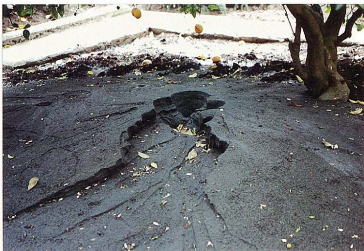
写真-10 (上) マリーナ地区で見られた噴砂
