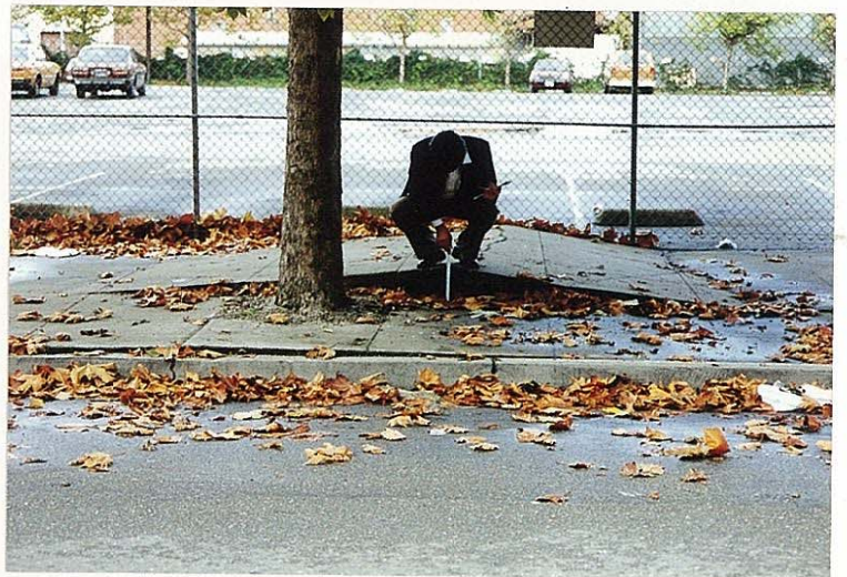
写真-3 (右) ミッション地区における歩道板の座屈 —— このような道路変状は液状化の発生した他 の地区でも数多く見られた。
