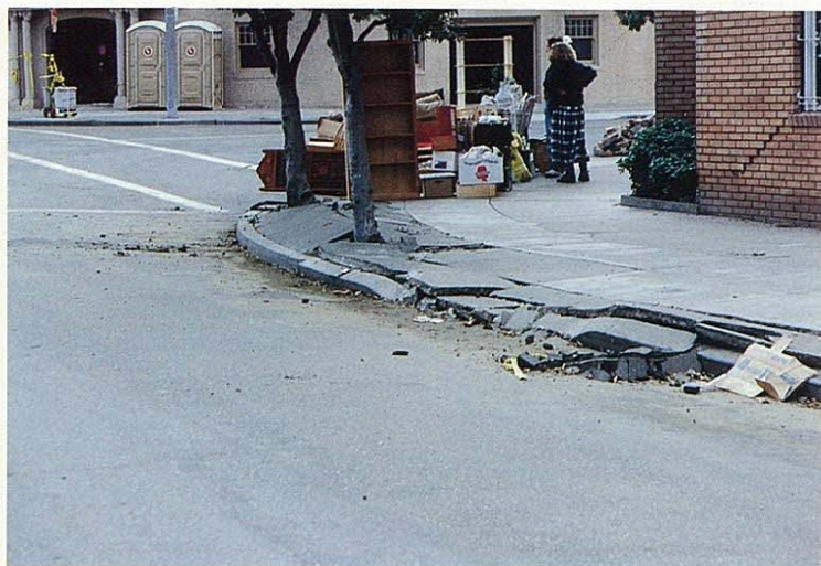
写真-13 (左) マリーナ地区の地盤変状
