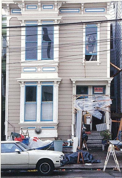
写真-1 (上) ミッション地区の家屋被害 —— 若干傾斜している。
