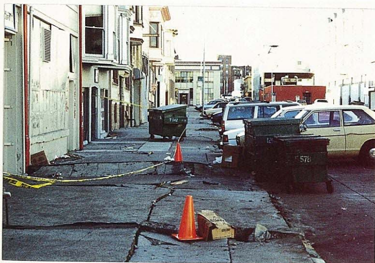
写真-4 (左) サウスマーケット地区の歩道の変状 —— この道路の写真は奥に向かって若干傾斜 している。歩道が波を打ったようになっ ている。
