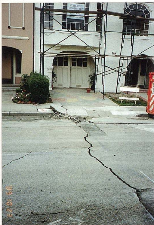
写真-9 (上) マリーナ地区の地盤変状と家屋被害
