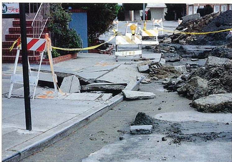
写真-12 (左) マリーナ地区の地盤変状
