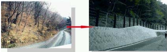
斜面・のり面の健康診断【▲対策前】
