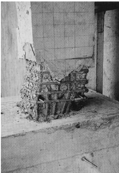
写真-2.2 曲げ破壊
