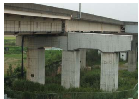
写真-1.8 ラーメン式橋脚
