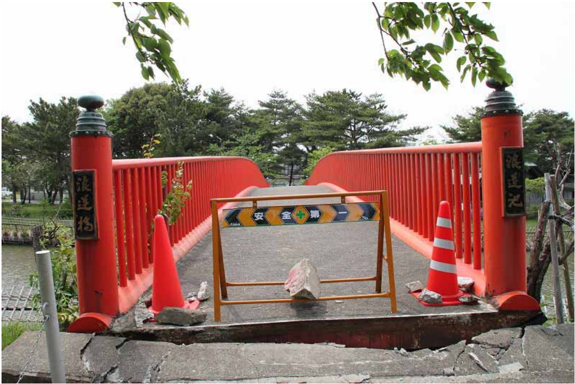
桁は傾いている。
