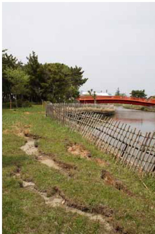
池周辺の地割れ
