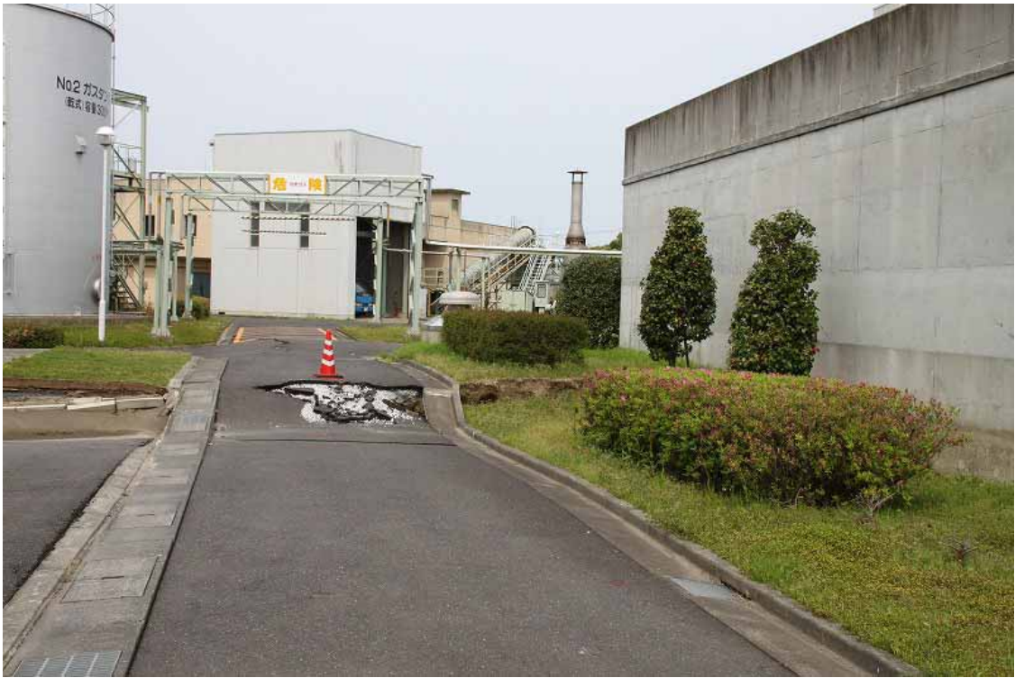
随所にこのような段差が見られた。
