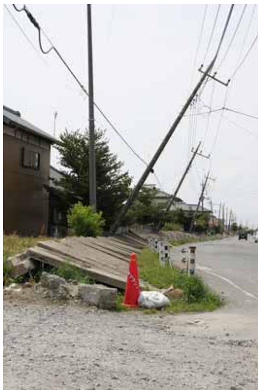
歩道の盛り上がりにも水路の浮上が伴ったものか。
