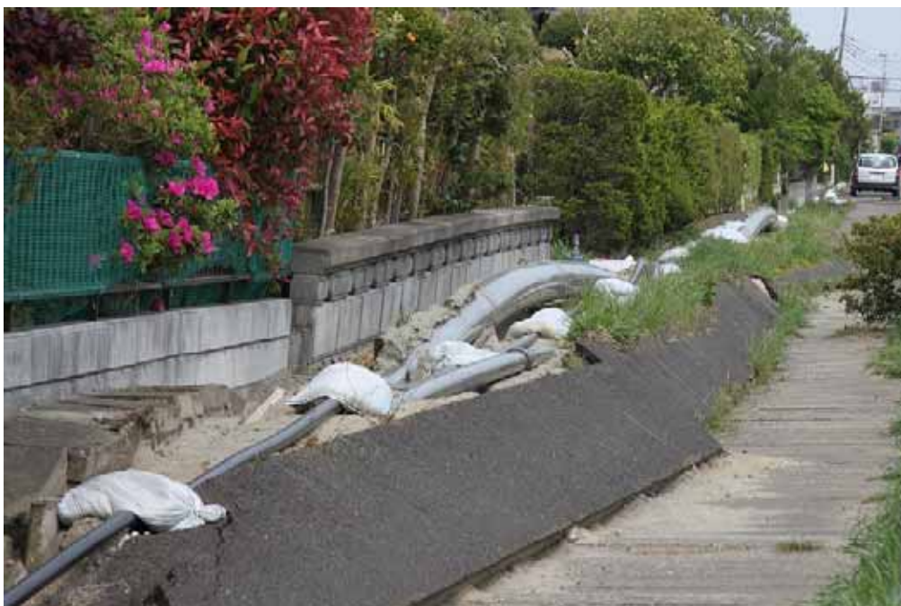
5丁目。管路の浮上も伴っている。
