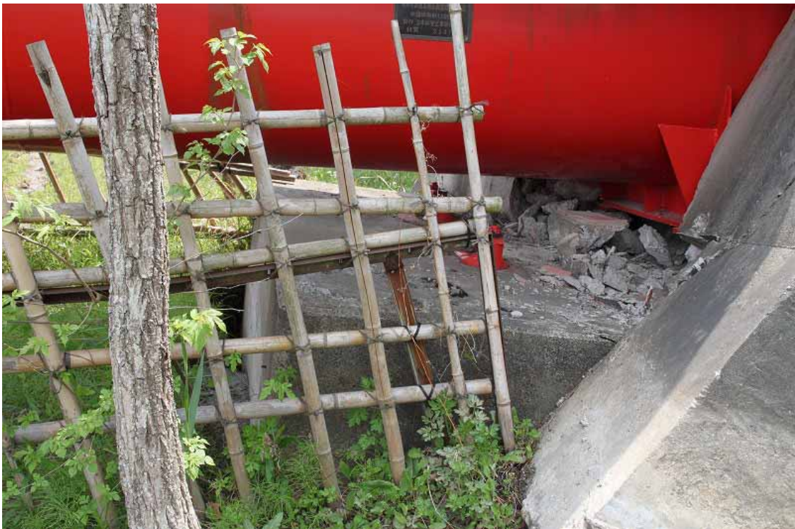
西側橋台、池（左）の方向に移動、傾斜、結果として支承が外れた。
