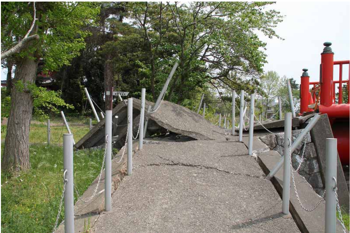
東側。橋が抵抗することにより橋台裏の地盤が圧縮されている。
