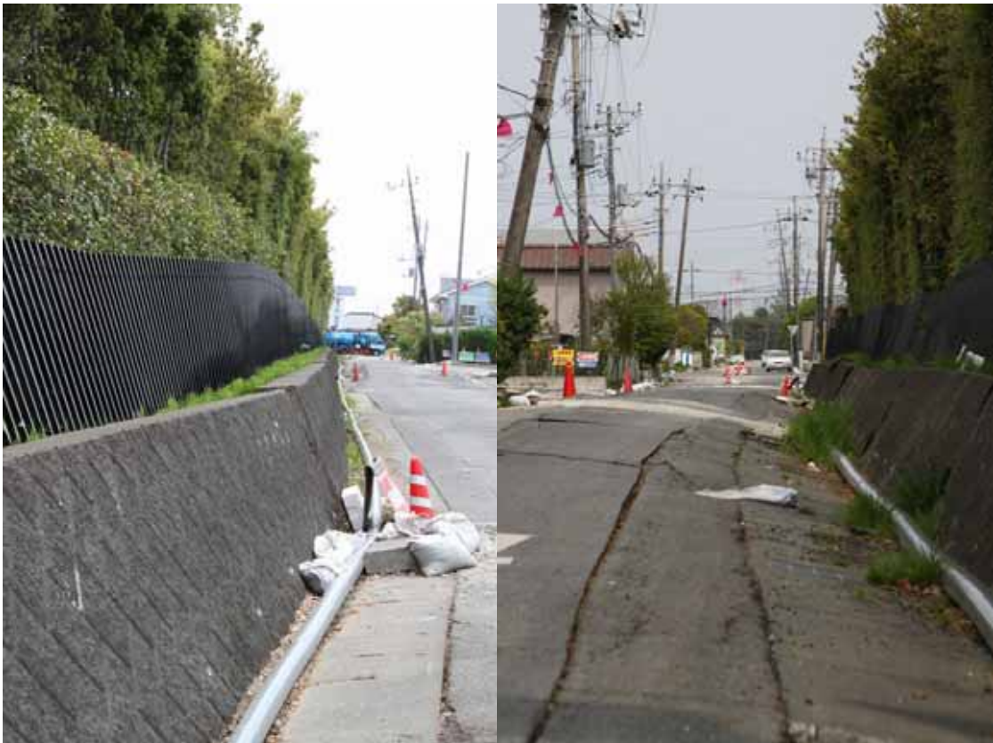
浄化センター北側の道路。擁壁が押し出され、路面が盛り上がっている。
