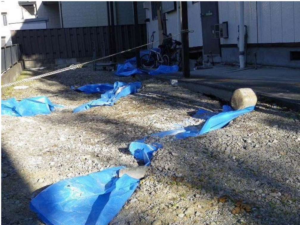
航空写真内②付近で見られた地盤の亀裂及び沈下変状。
