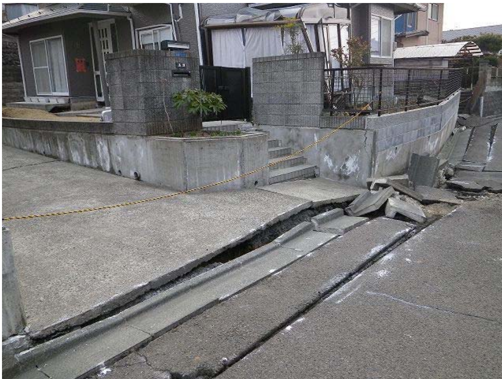
航空写真内③(道路を挟んで高台側)。家屋側壁がはらみ出している。
