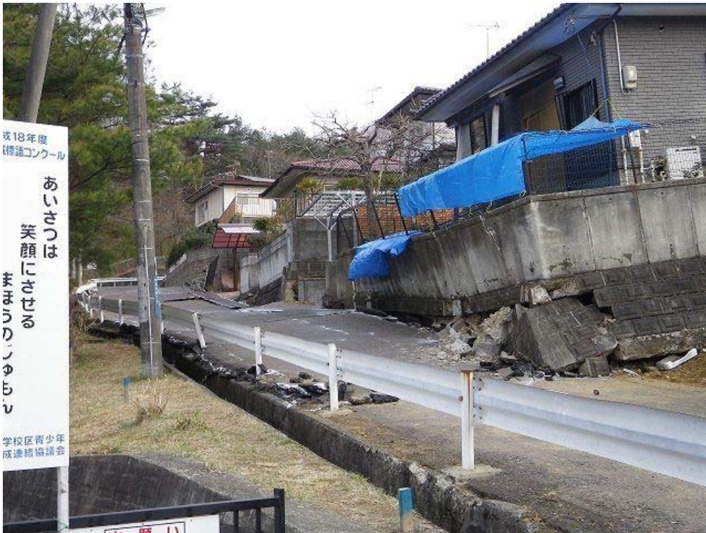
航空写真内①. 小学校側に向かって道路の及び家屋側壁がはらみ出している。
