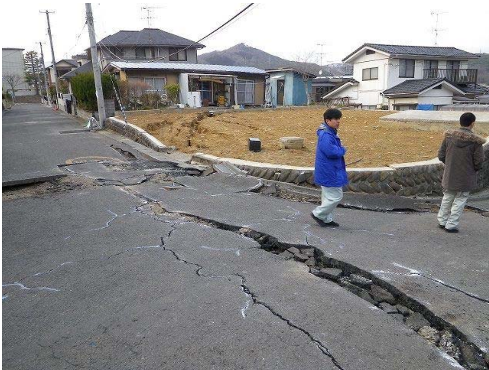
航空写真内②。写真右手に向かって下り傾斜。一部路面の沈下変状が見られる。
