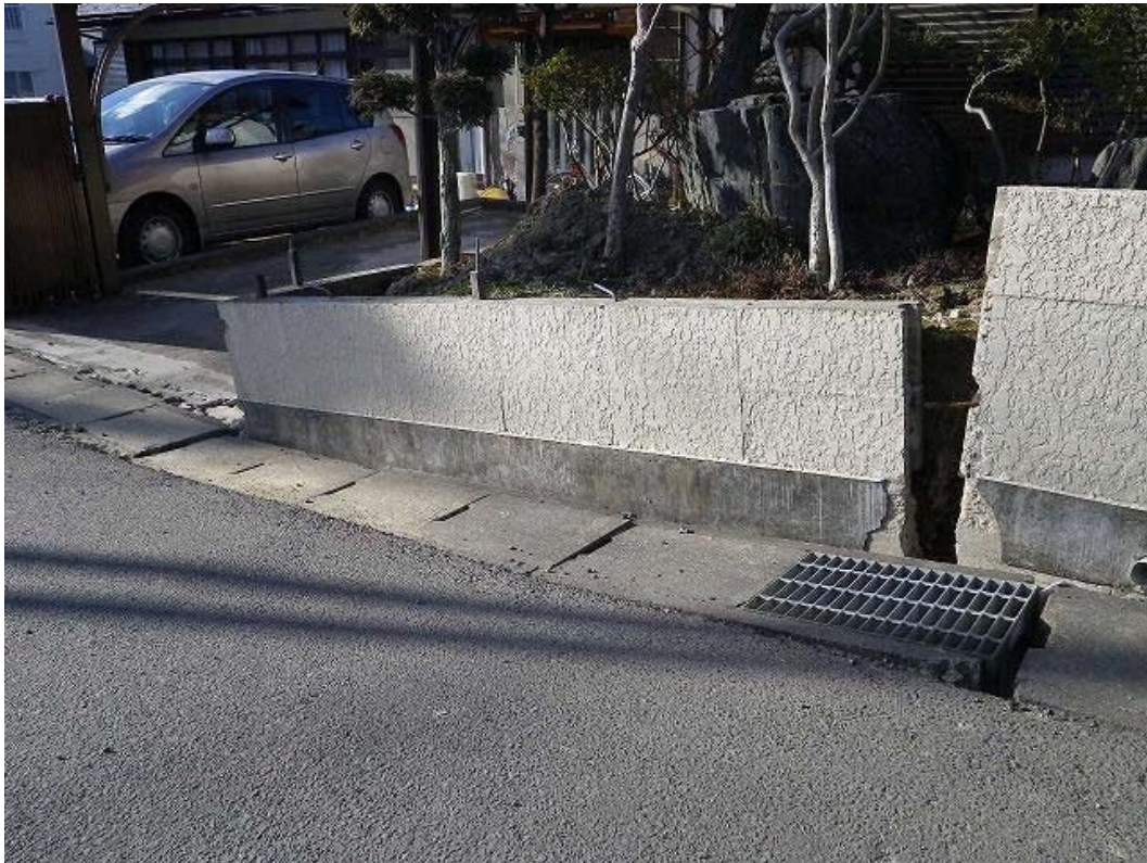
航空写真内①に見られた路面の沈下及び外壁の段差。
