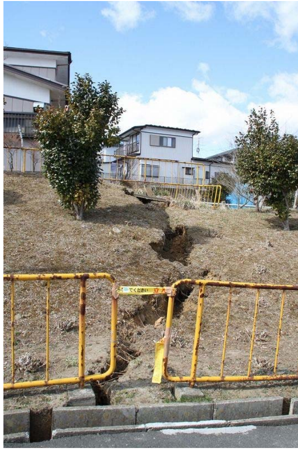
4号緑地の亀裂
