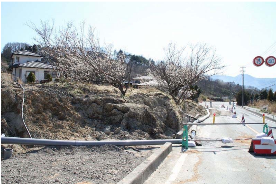
歩道に完全に乗り上げている。
