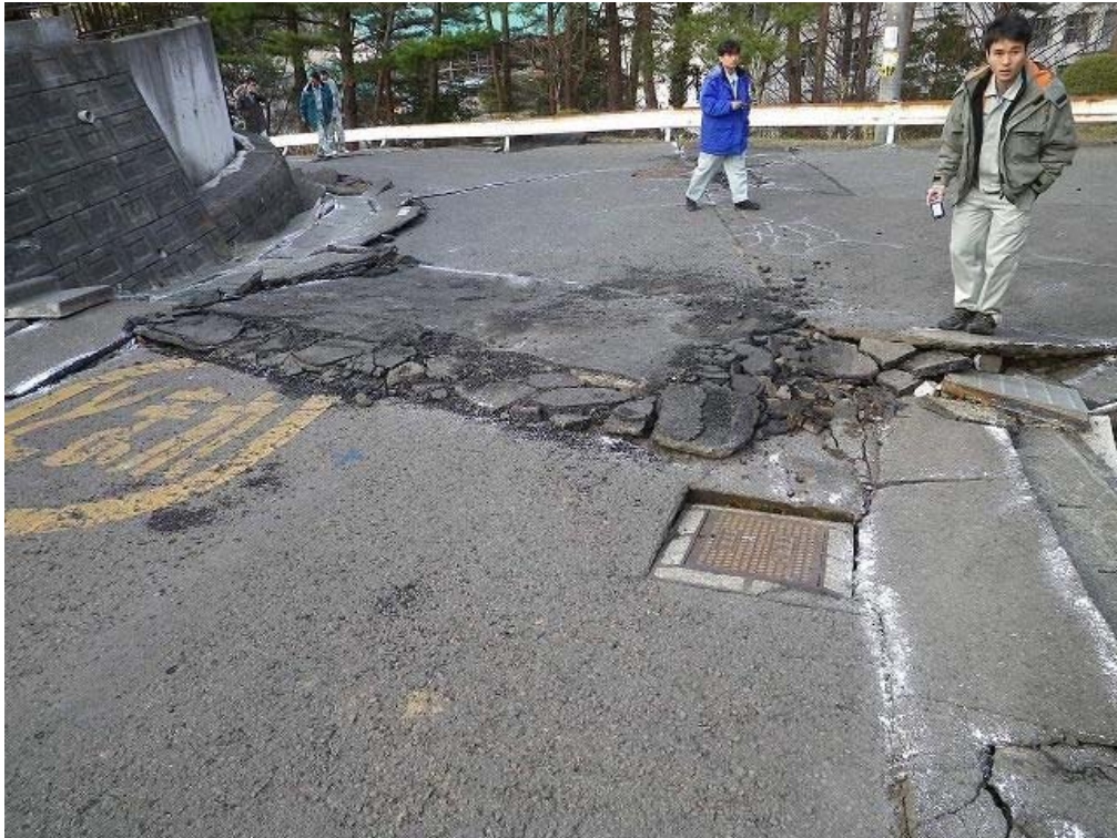
航空写真内②（小学校側）。道路に亀裂が走っている。
