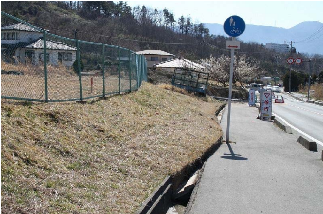
道路に押し出された地盤
