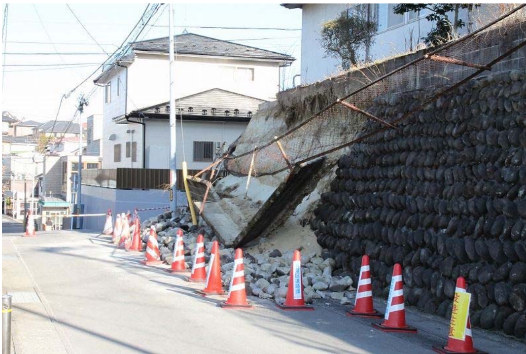
航空写真内①付近の擁壁の崩壊。仙台市内はこのタイプの擁壁が多いが被害は少ない。
