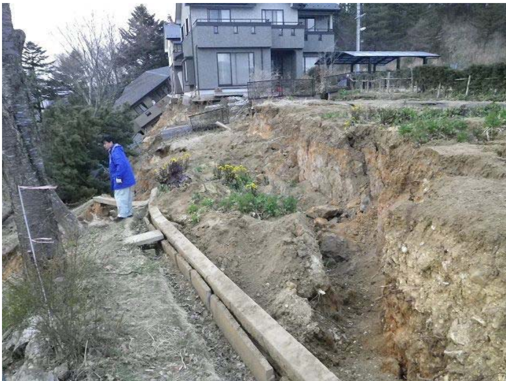
地盤のすべり破壊。それに伴い、奥に見える家屋は傾斜し、谷底に落ちかけていた。
