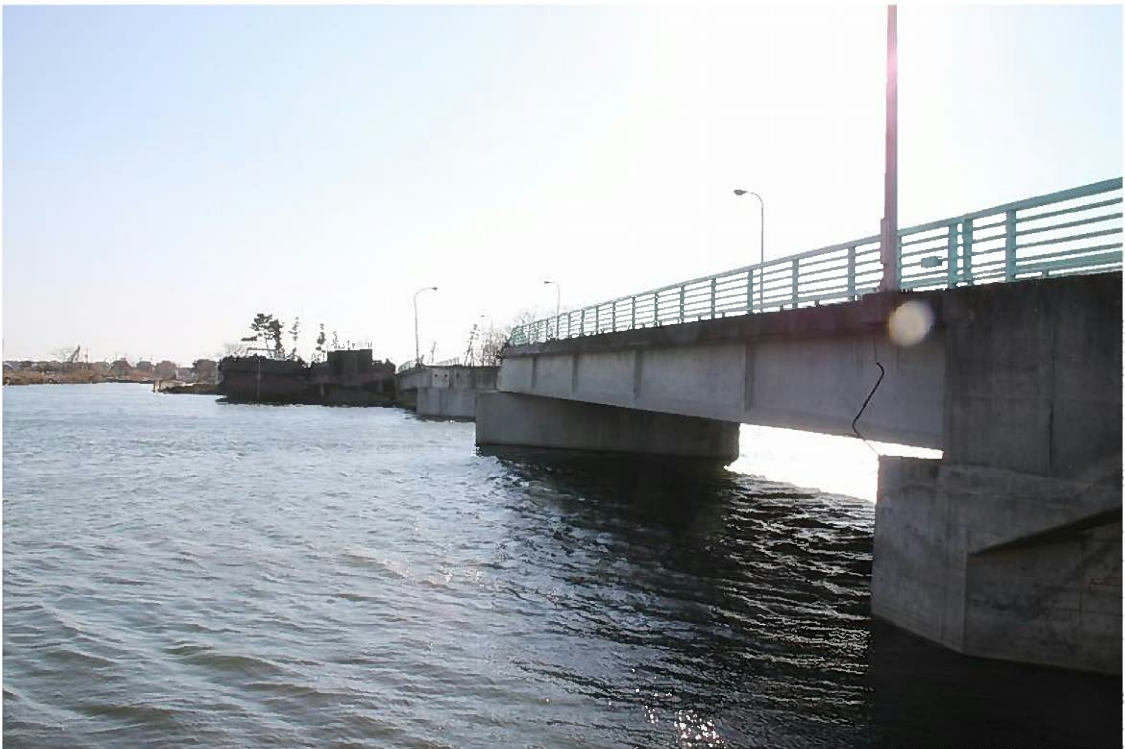
247 号線の橋梁。中央径間が津波で流されている。
