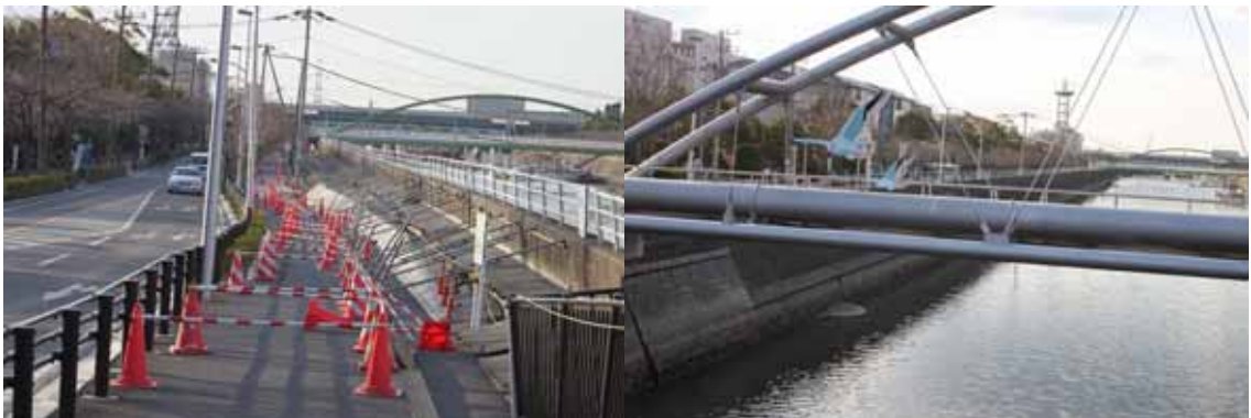
今川橋西詰の護岸背後の沈下、その河川側の状況。護岸下から噴砂。水管橋は被害なし。
