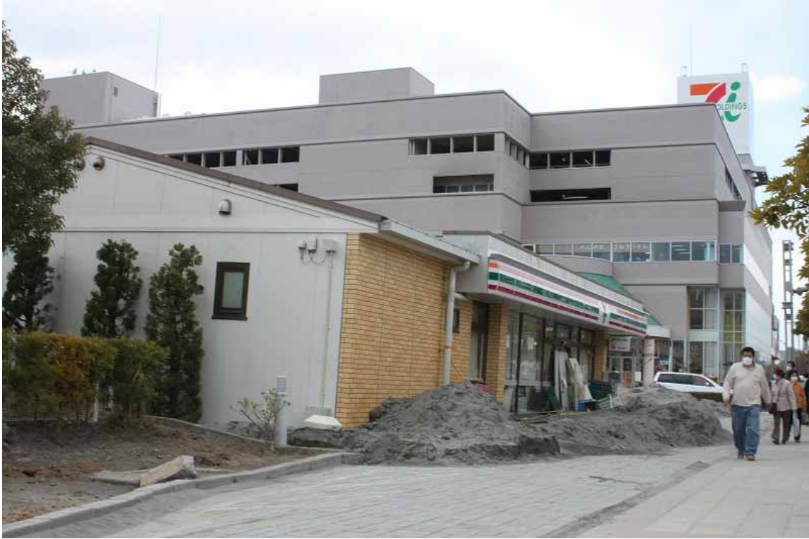
傾斜、沈下したコンビニ
