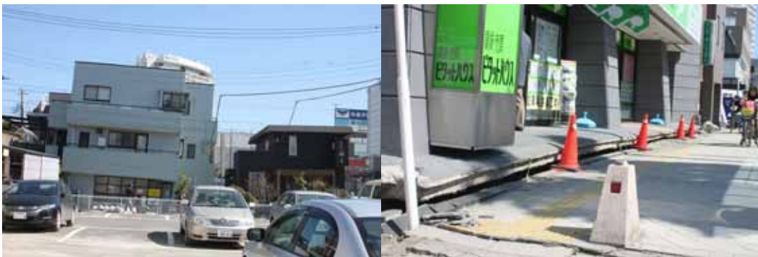
左：傾斜した家 右：歩道沈下。町全体が沈んでいる。
