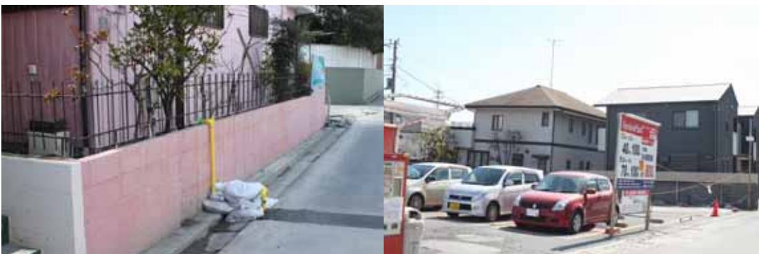
左；ガス管の応急復旧 右：傾斜した家
