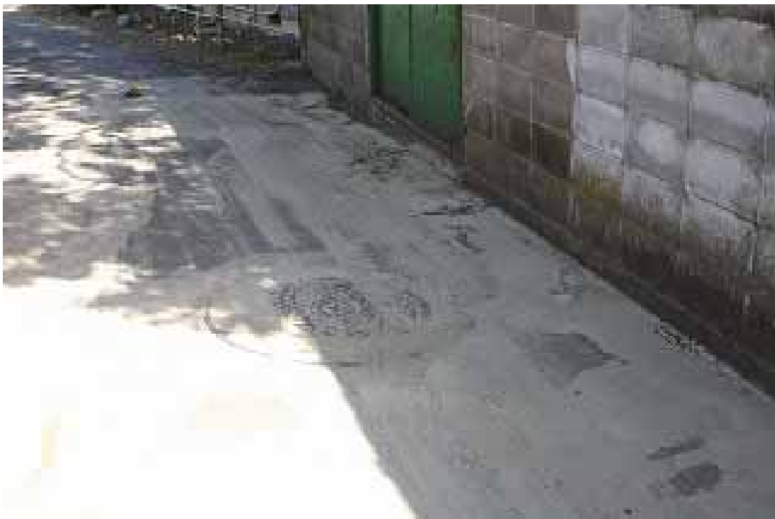
土浦駅の西側は地盤変状は見なかった。中央1丁目周辺で見つけた唯一の噴砂。
