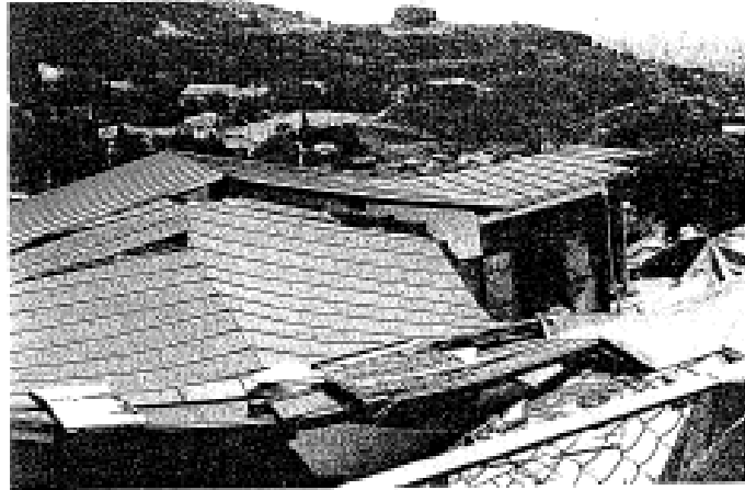
写真8.1 鎌倉市緑ヶ丘1丁目の傾斜地造成 宅地に建てたもので基礎のわら棒が 平家建の安定した姿で、老朽化もなく 建物自体の耐震性はほぼ満足すべきもの でありながら地割れによって、このよう な惨状になった例（飯塚五郎撮影）
