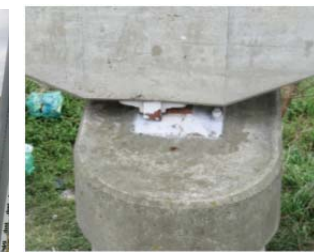
写真21 固定支承脱落
