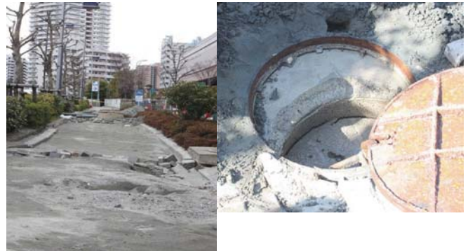
写真1 管路被害の事例（浦安市）
