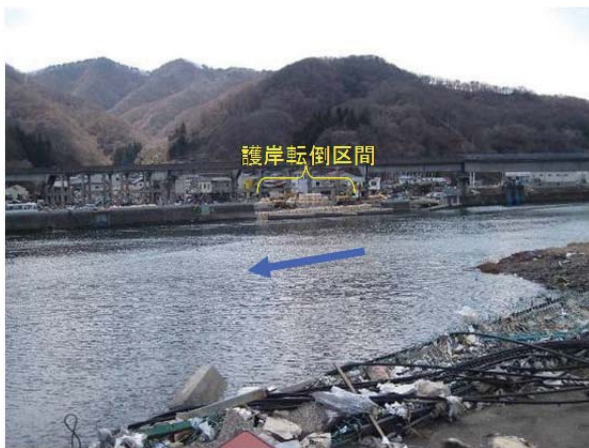
写真4 甲子川 護岸転倒状況
