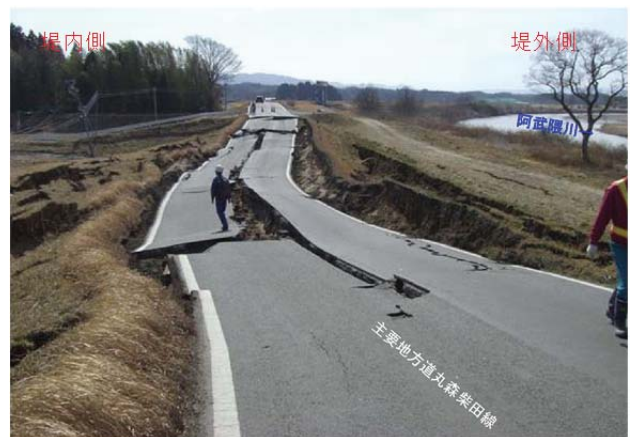
写真5 震災直後の被災状況 6)
