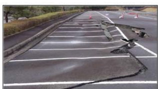
写真 32 駐車場の側方流動
