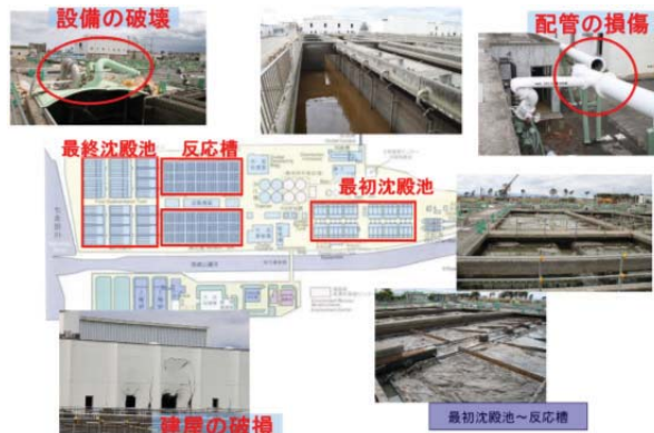
図 6 蒲生浄化センター被災状況
