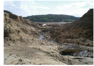
④ 右岸側破堤断面
