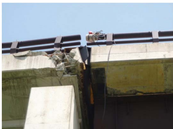
写真15 相馬東大橋の被災状況
