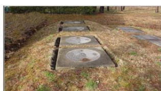
写真 29 浄化槽の浮き上がり
