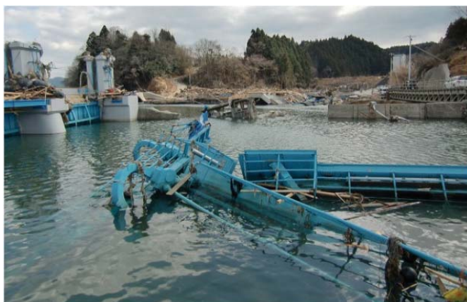
写真8 操作橋・管理橋の流出
