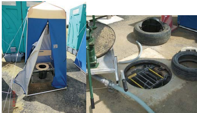
写真4 仮設トイレの設置事例 (注) 右：洋式型トイレ、左：フラッシュ用マンホール
