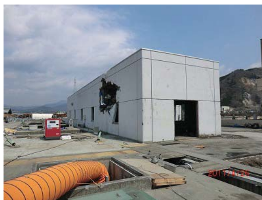
写真7 津波被害を受けた処理場の事例(大船渡市)
