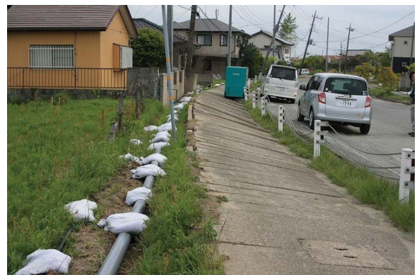
写真2 仮設配管の事例（潮来市） （注）併設は上水道管（左）
