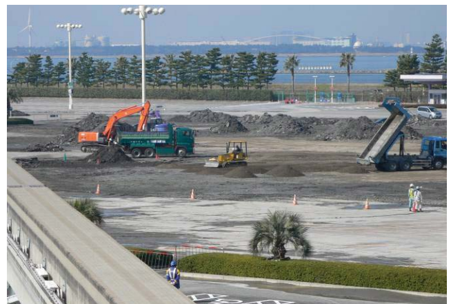
写真8 ディズニーランド駐車場での噴砂の発生状況 (片付作業中)
