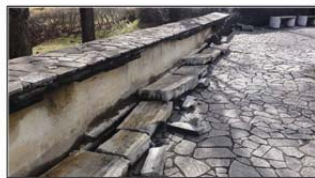
写真 33 小端積の倒壊
