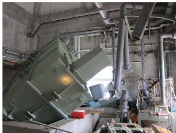
写真 26 蛸の浦浄化センター内部被災状況
