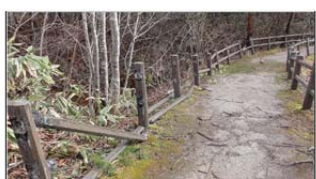
写真 30 柵のビーム部の脱落
