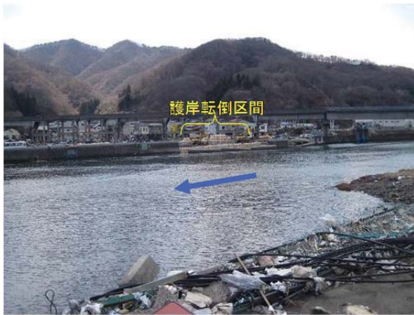
写真4 甲子川 護岸転倒状況
