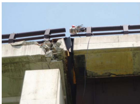
写真15 相馬東大橋の被災状況
