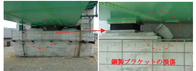
写真 13 変位制限装置の損傷（新天王橋）
