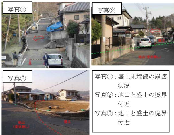
写真 24 未対策造成地盤の被害状況 (折立地区)
