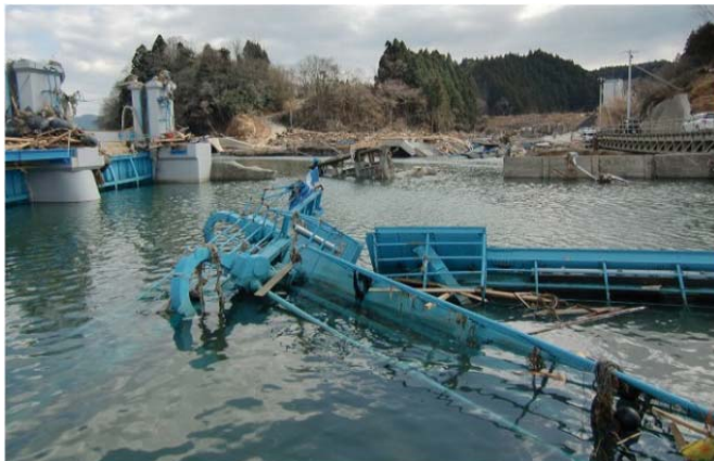
写真8 操作橋・管理橋の流出
