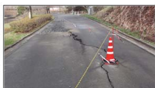
写真 31 園路のクラック
