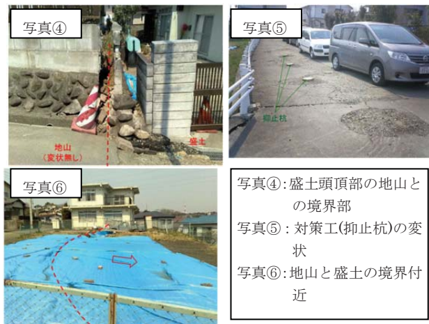
写真 25 対策済造成地盤の被害状況 (緑ヶ丘地区)
