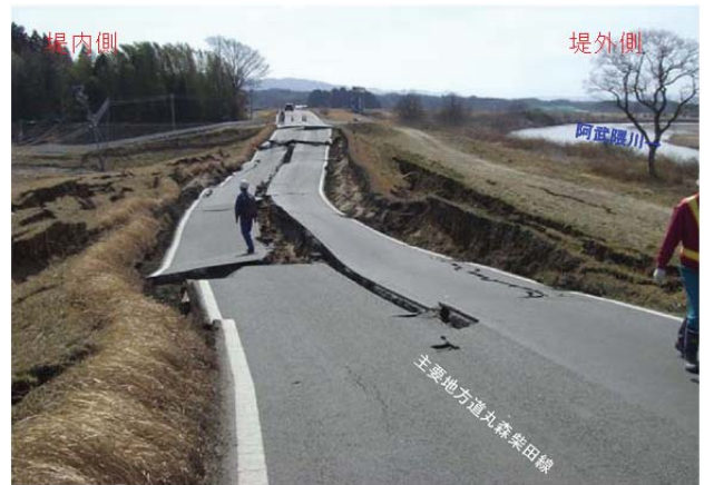
写真5 震災直後の被災状況 6)
