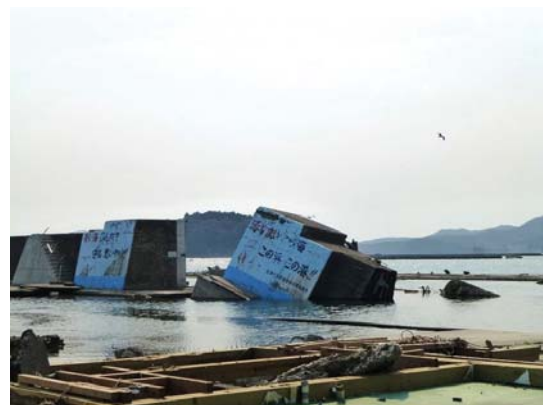
写真3 海岸施設の被災状況 (南三陸地区)
