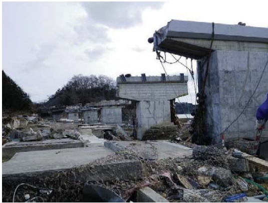
写真4 道路橋の津波による桁の落下の状況 (国道45号 南三陸地区 歌津大橋)
