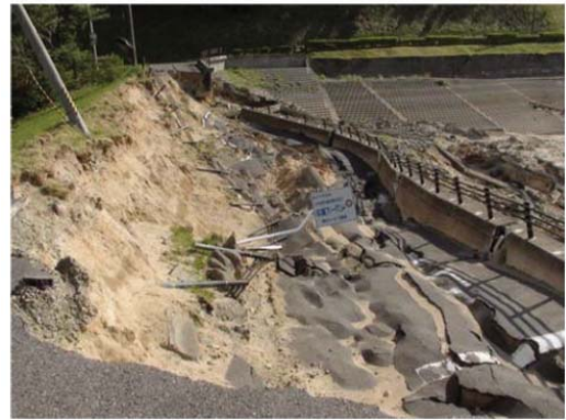
写真6 福島県 藤沼貯水池の被災状況
