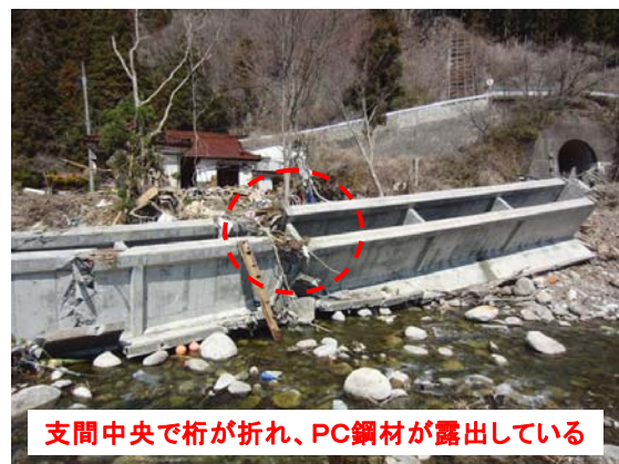
写真9 荒川橋上流の南リアス線の落橋
