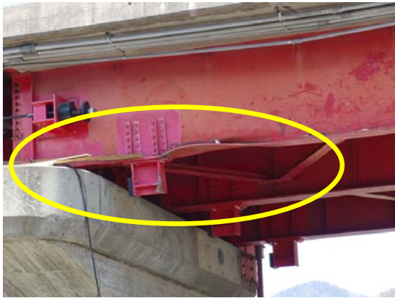
写真7 片岸大橋 上部工の変形
