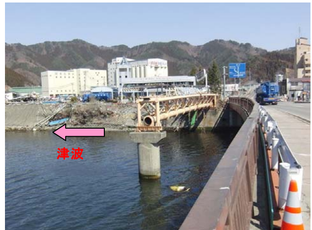
写真6 矢の浦橋上流側の水管橋の流失
