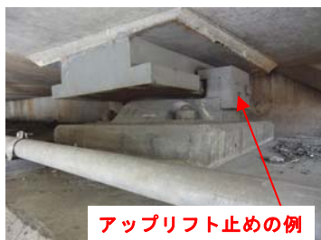
写真 14 アップリフト止めの有る支承
