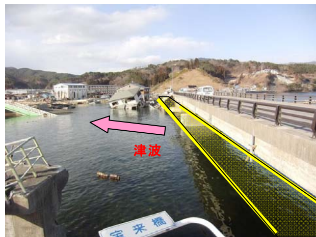
写真3 宝来橋側道橋の流失状況
