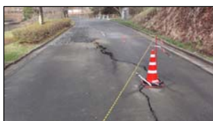
写真3 園路のクラック
