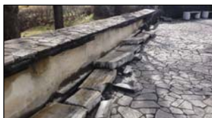
写真5 小端積の倒壊
