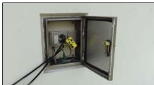
写真15 端子箱からの電力供給
