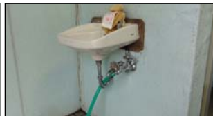
写真16 屋外便所手洗いからの給水
