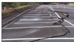
写真4 駐車場の側方流動
