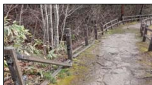
写真2 柵のビーム部の脱落
