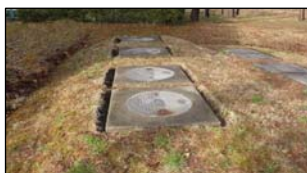
写真1 浄化槽の浮き上がり
