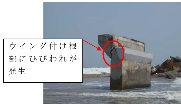
写真-2 小塚橋被災状況(その2)
