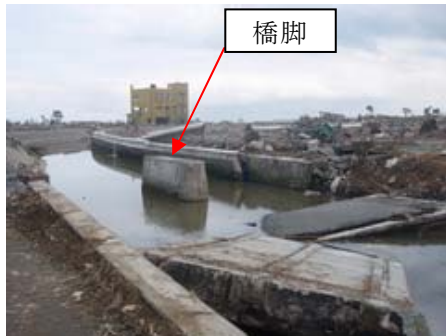
写真-3 釣師橋被災状況
