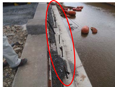
写真-16 上立切橋の被災状況(その2)
