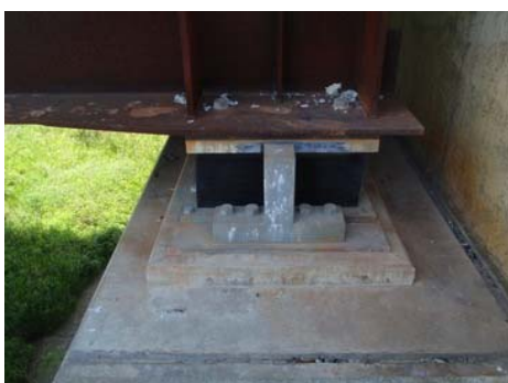
写真-10 支承の被災後の状況
