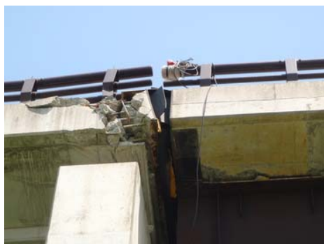
写真-9 相馬東大橋の被災状況(その2)
