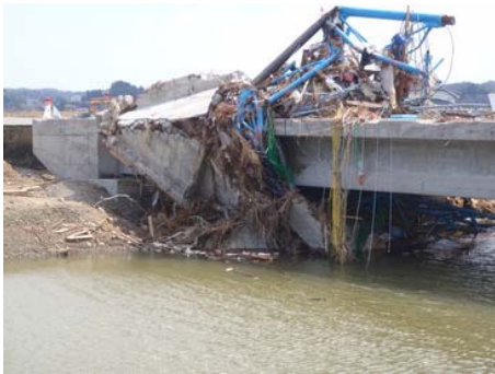
写真-13 新館野橋の被災状況(その2)
