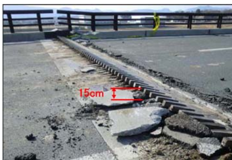
写真-8 相馬東大橋の被災状況(その1) (磐城国道事務所ホームページより)
