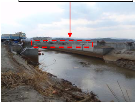
写真-15 上立切橋の被災状況(その1)
