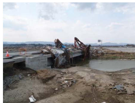
写真-12 新館野橋の被災状況(その1)
