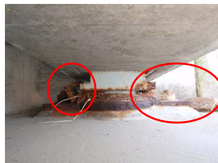
写真-7 浜畑橋の支承の浮き上がり(その2)
