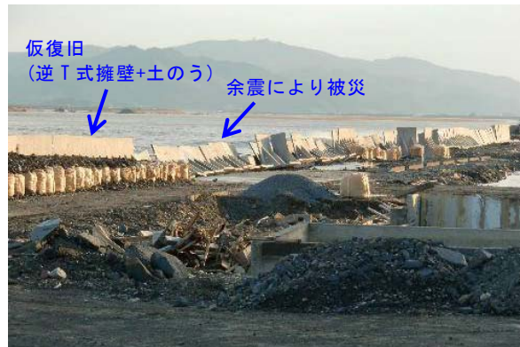
写真 4 仮復旧された堤防の被害
