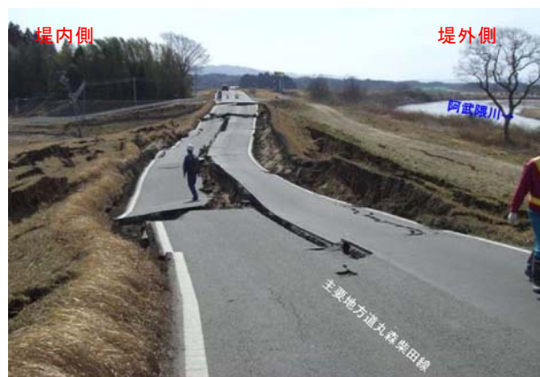
写真7 震災直後の被災状況 6)
