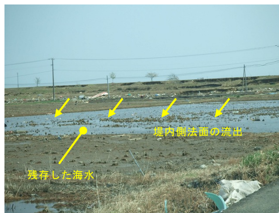
写真 1 堤防法面の流出
