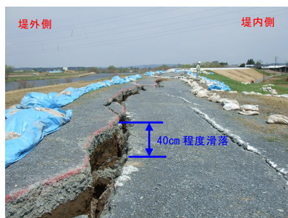
写真9 堤防天端の被害
