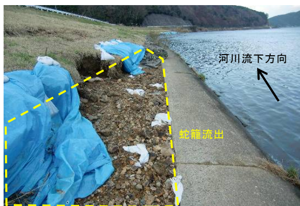
写真5 堤防法尻部(堤外側)の被災状況
