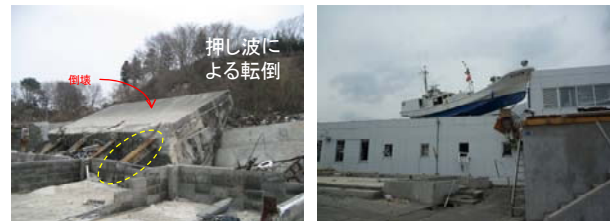
写真2 防潮堤破壊と堤内の様子
