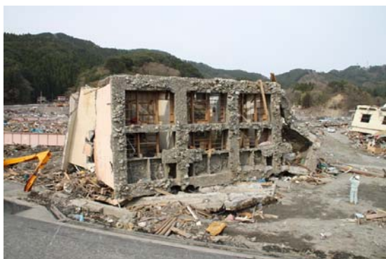
被害調査の様子 岩手県大槌町にて
