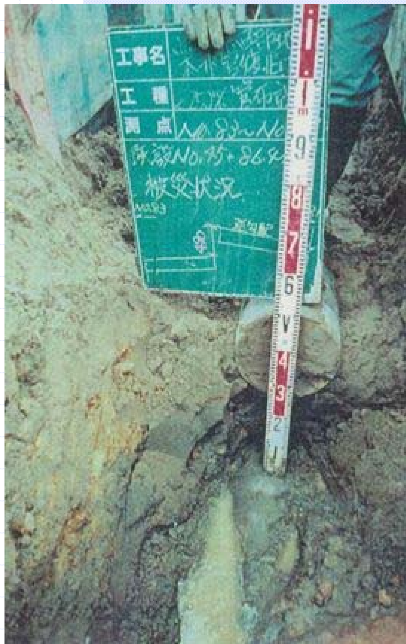
写真④ 管渠のずれ（約50cmの段差および逆勾配） 29
