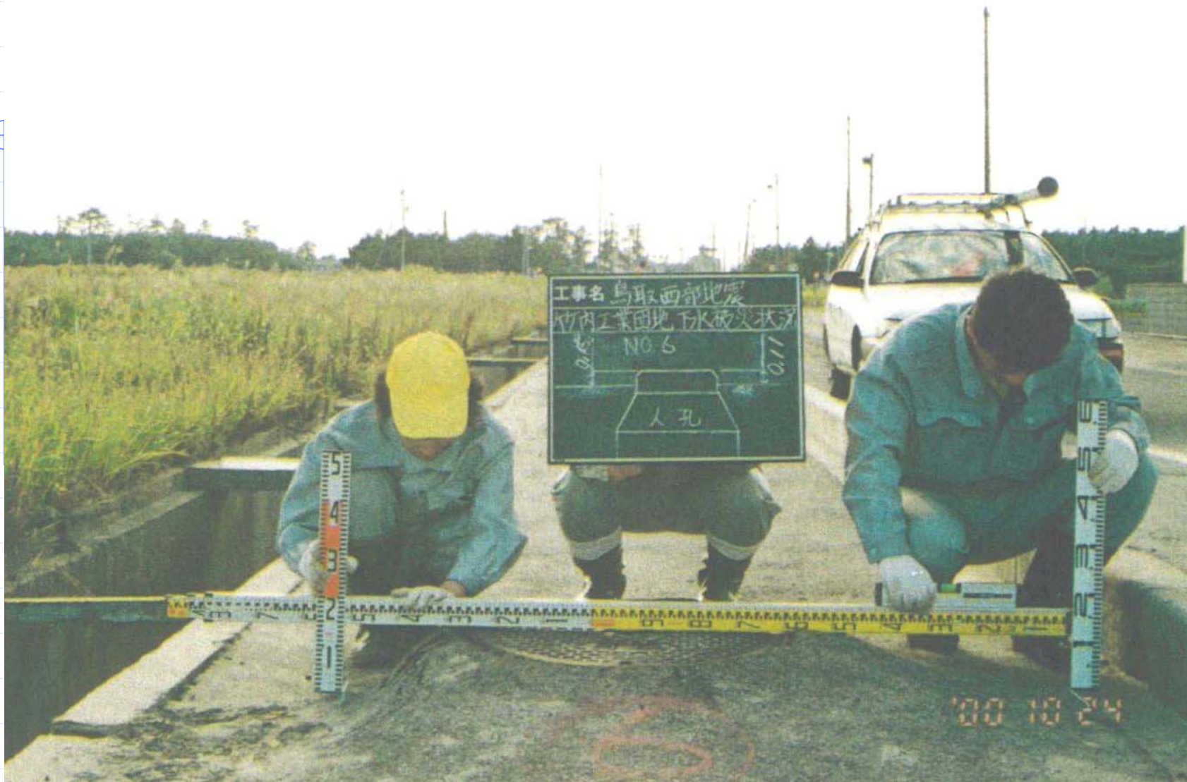
竹内団地 マンホールの浮き上がり (約15.0cm)
