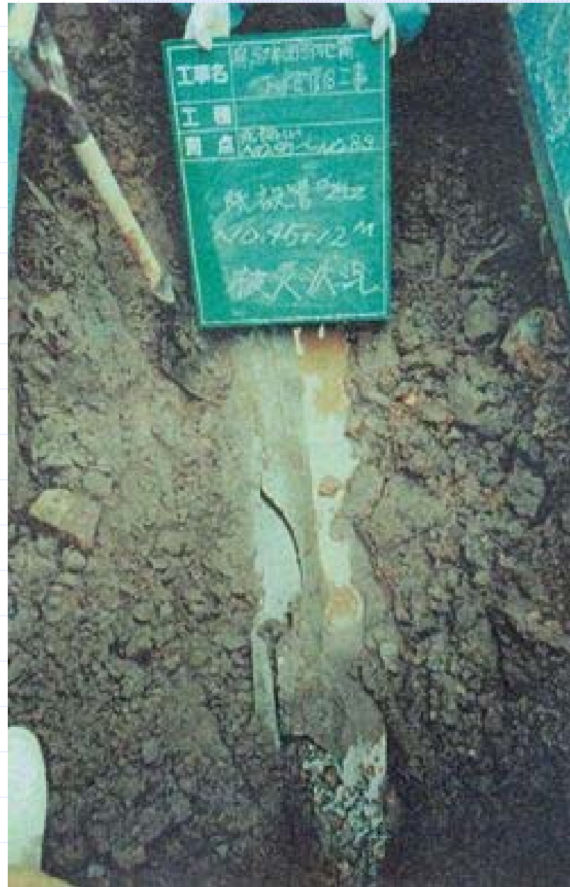
写真② 塩ビ管の破損
