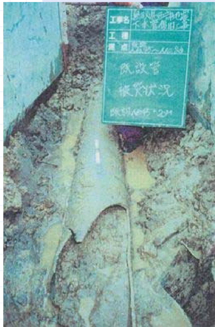
写真③ 塩ビ管の破損
