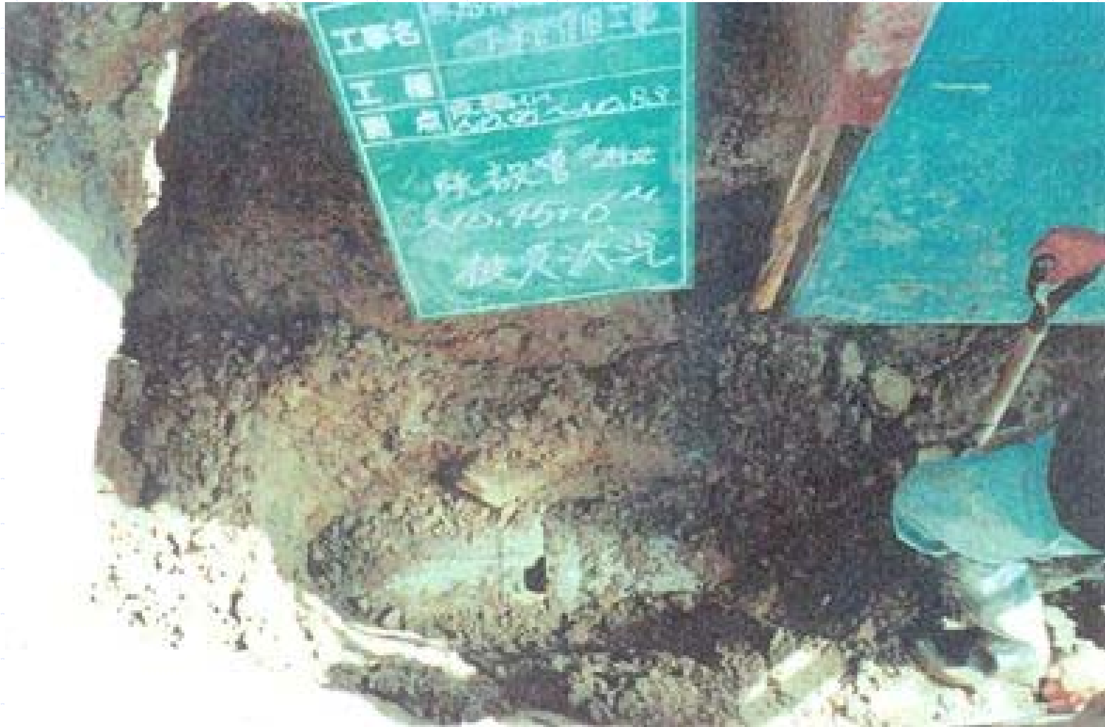
写真① 塩ビ管の抜け出し
