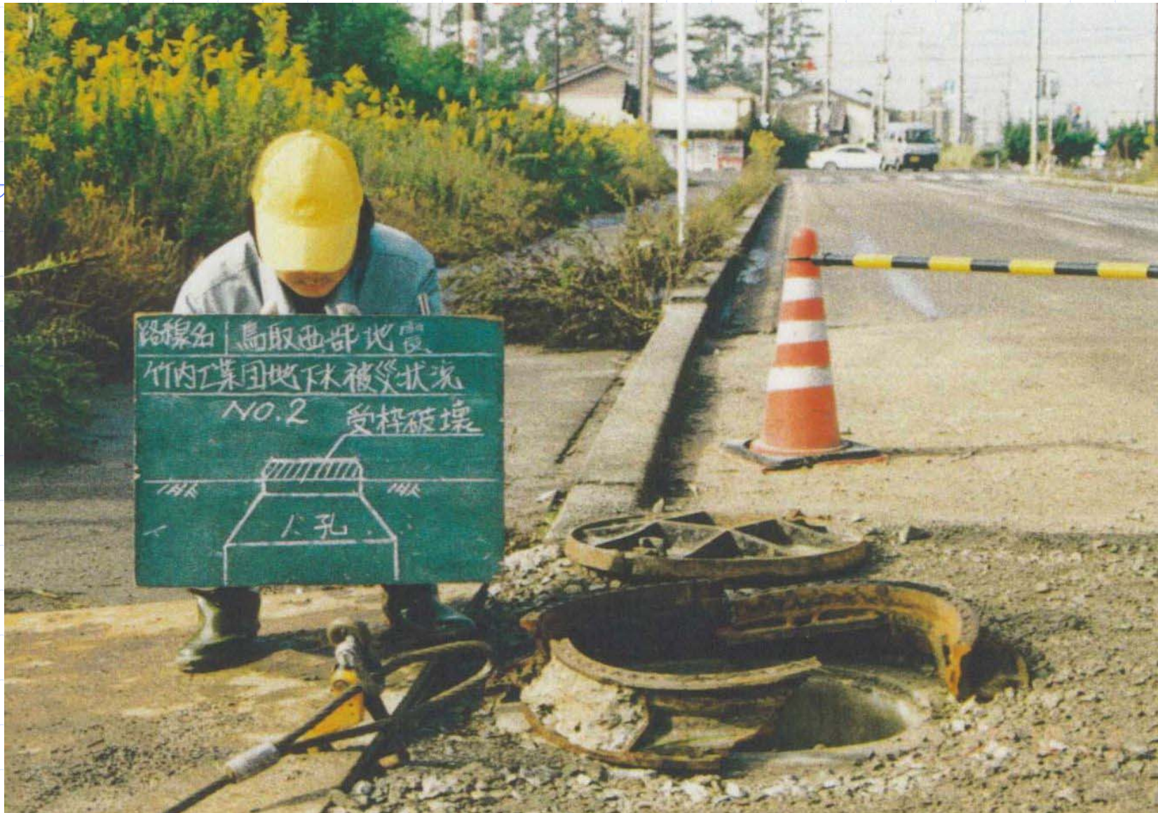
竹内団地 マンホール受枠の破損
