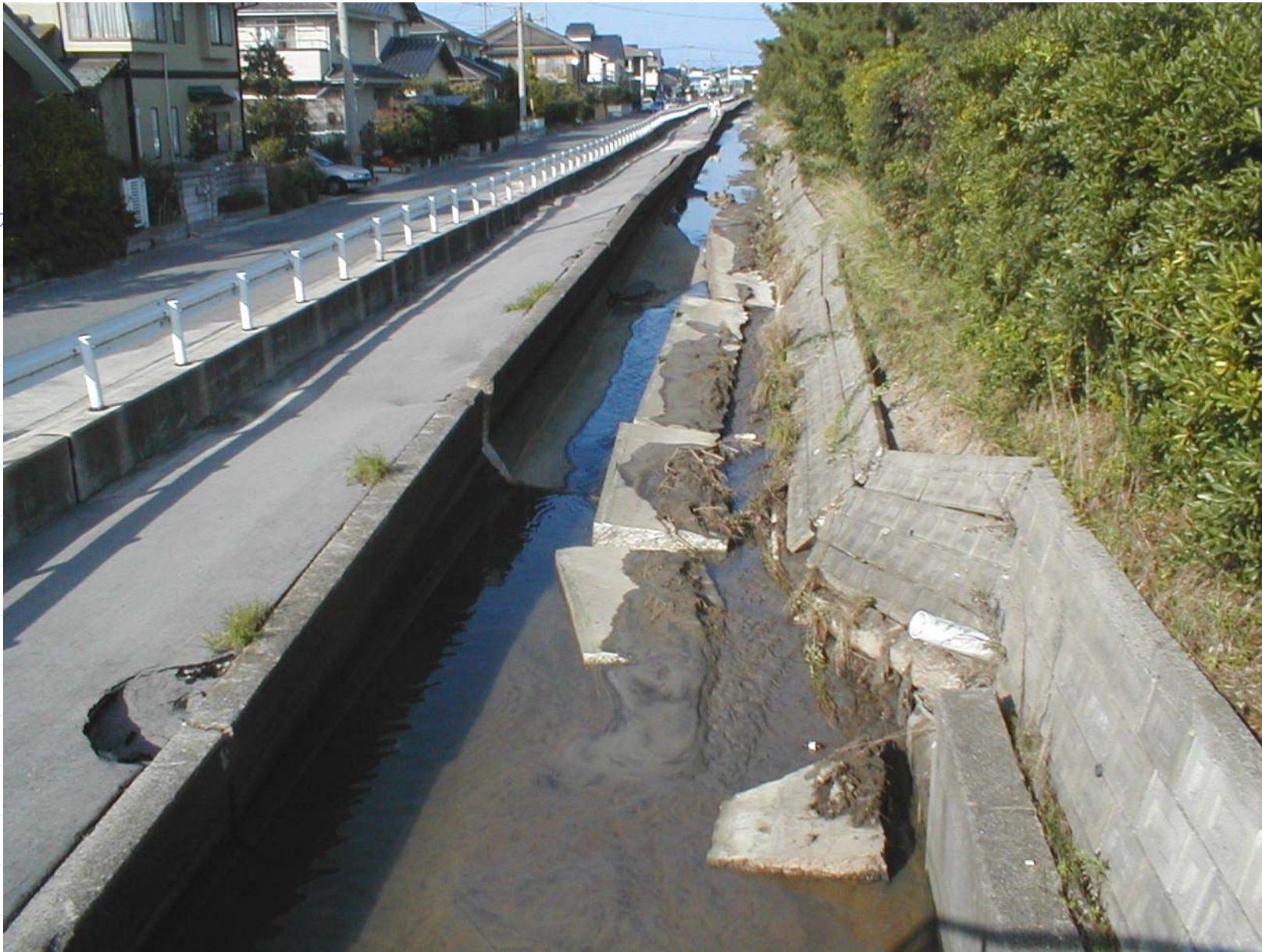
安倍彦名団地の被害状況（水路の被害）
