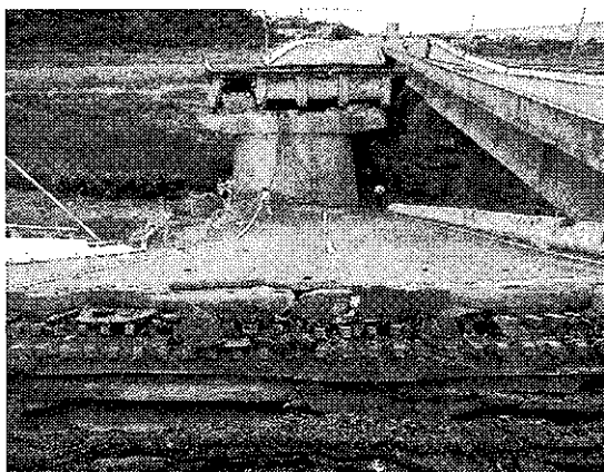
写真-9 烏溪橋 上流側橋梁の落橋
