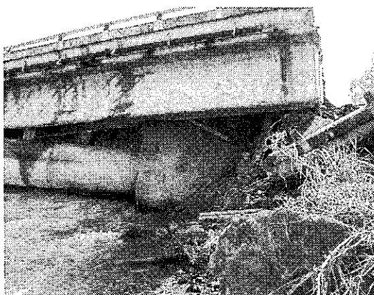
写真-19 卑豊橋 ケーソン基礎の転倒
