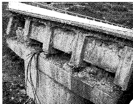
写真-10 烏溪橋 支承部の損傷状況
