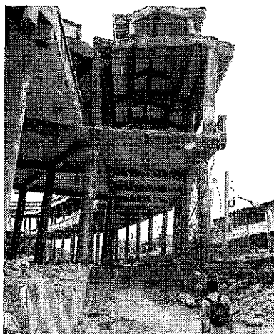
写真-23 代金天仙宮府 ラーメン構造の損傷
