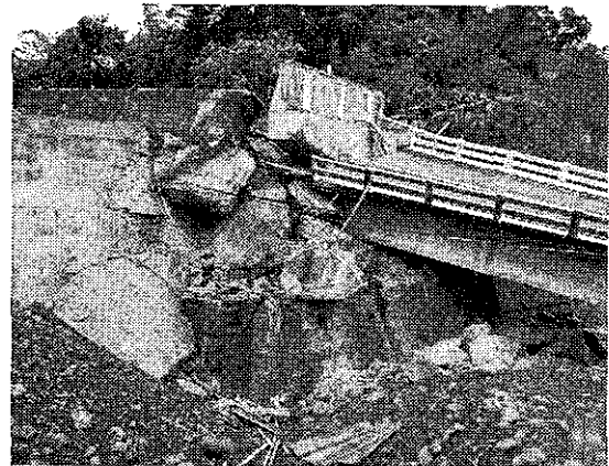
写真-14 桶頭橋 橋台背面盛土のはらみだし
