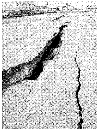
写-4 草津港岸壁エプロン 背後地盤の沈下と亀裂
