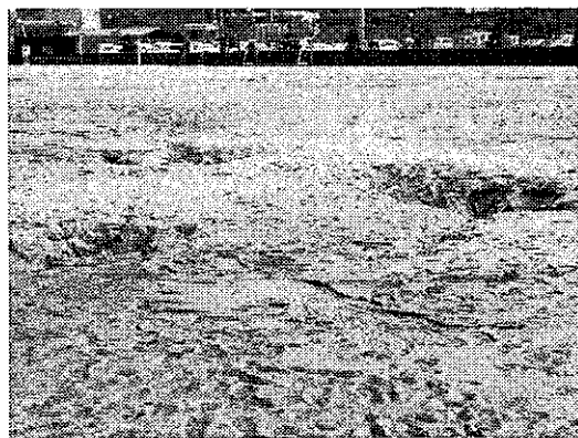
写-5 三菱重工グラントの液状化噴砂跡 (噴砂孔が大きく深いのが特徴)
