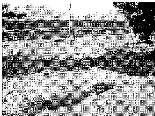
写-2 歩道脇樹林帯部の液状化噴砂跡 (やや粗い非常にきれいな砂で貝殻が多い)
