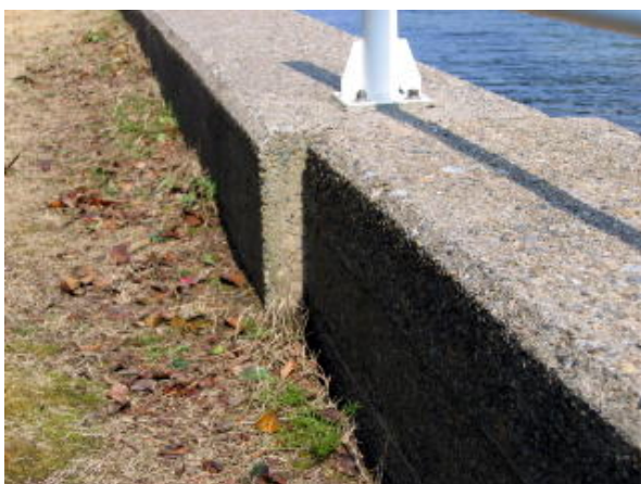
(e)岸壁のずれ
