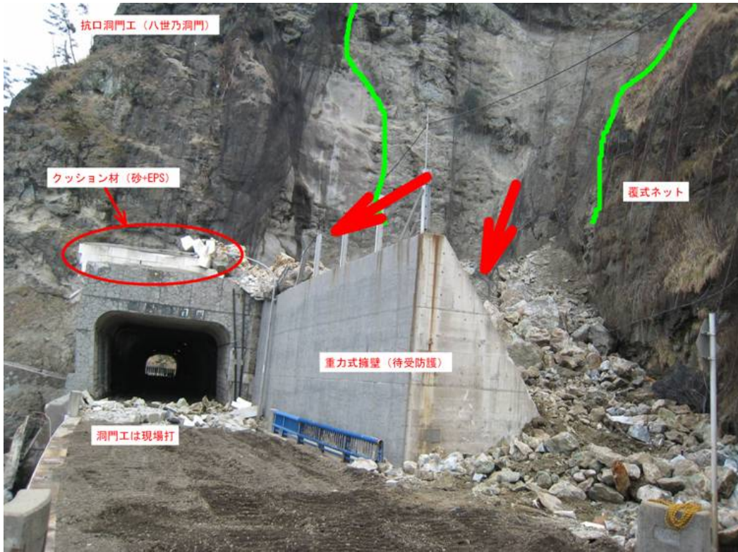
写真 3.2 八世乃洞門の被害概況
