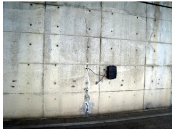
(d)センサー設置状況
