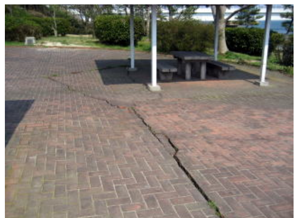
(f)広場での亀裂
