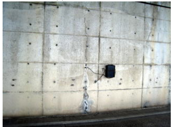
(d)センサー設置状況
