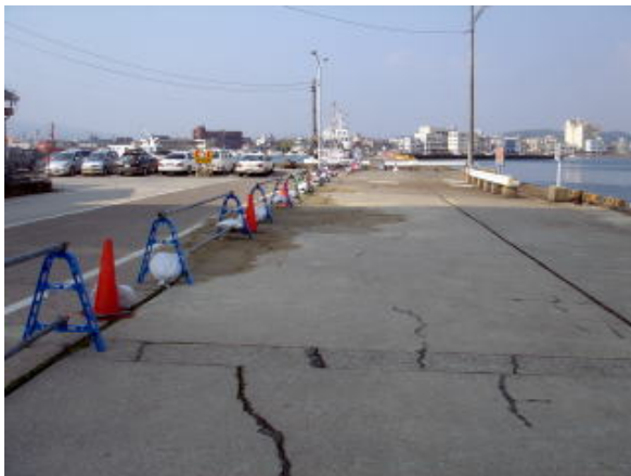
(a) 矢田新町の岸壁での噴砂・亀裂
