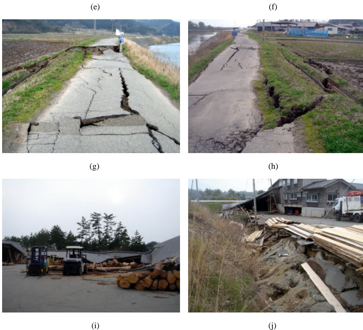
写真 5.3 輪島市門前町道下の鹿磯橋付近の被害
